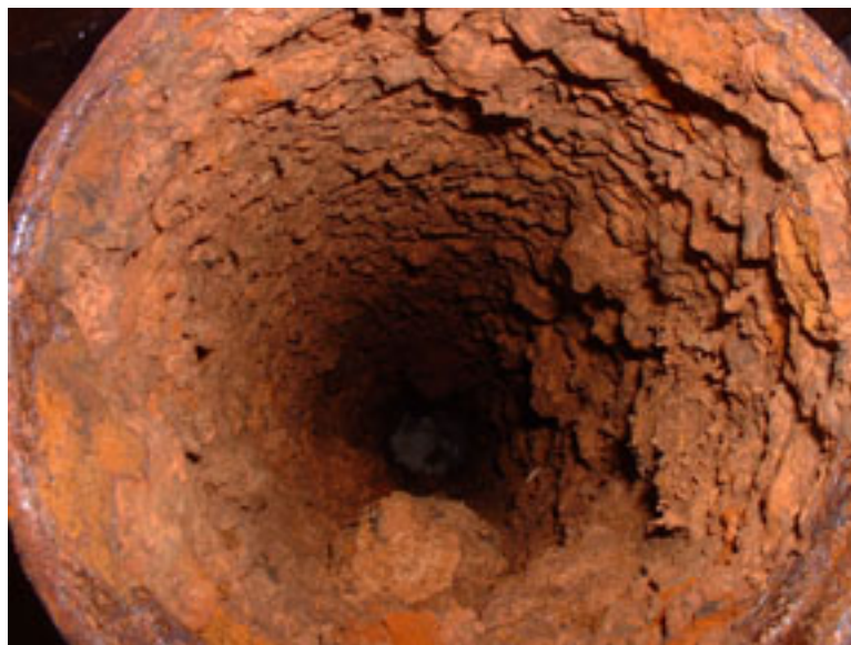
Figure VI.1 : Corrosion interne dans une conduite
