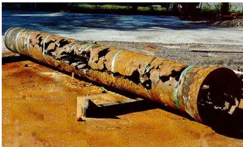
Figure VI.2 : Corrosion externe d'une conduite en fonte
