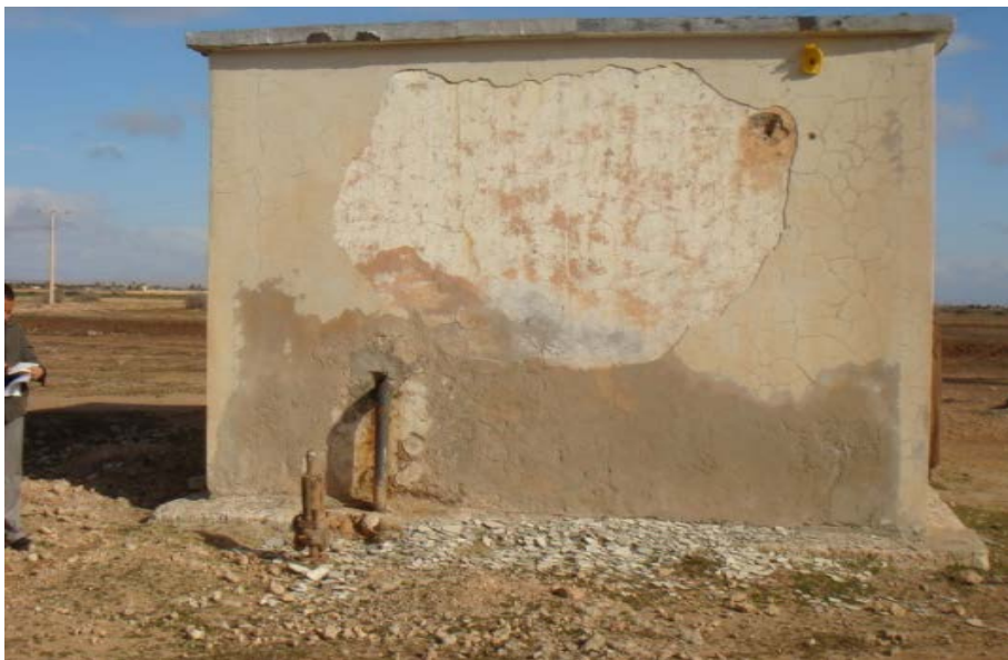
Figure II.01 : Dégradation de l'abri du forage 2.
