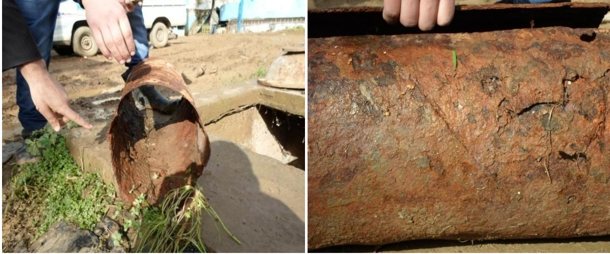
Fig 3.20, 3.21 : Bouts de conduite en acier enlevé lors de la réparation des fuites
