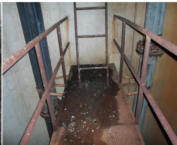
Fig 3.7 : Etat des échelles et rampes de repos
