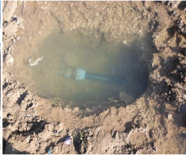
Fig 3.17 : Fuite sur une conduite en PEHD
