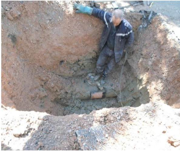
Fig 3.16 : Fuite sur la DN250 acier
