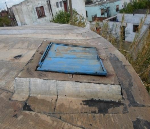
Fig 3.9 : Etat de la toiture
