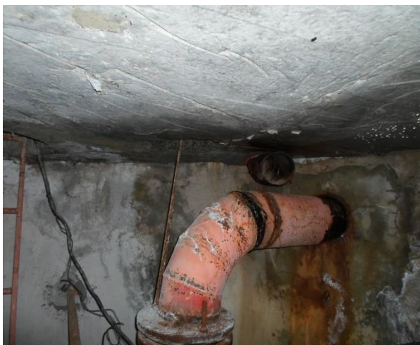
Fig 3.6 : Etat de la peinture intérieure
