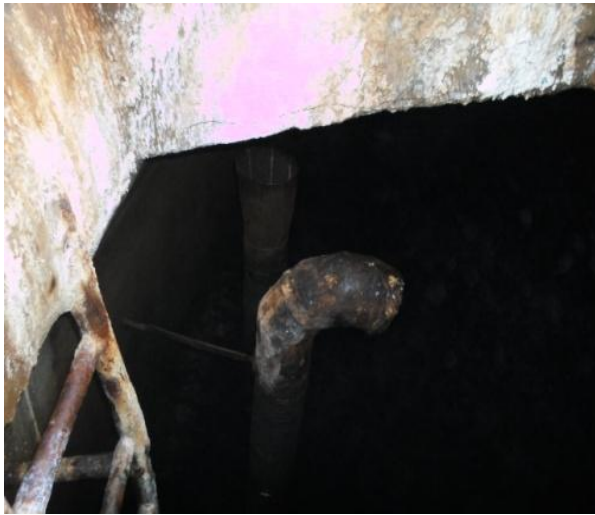
Fig 3.11 : Etat de l'échelle
