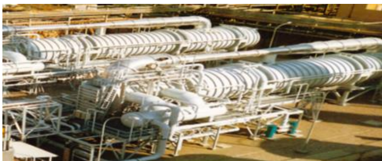
Figure III.12 : Unités de 4 effets + éjecto-compression (2 x 5.000 m 3 /j) mises en service à Tripoli (Libye) en 1999 par SIDEM. [31]
