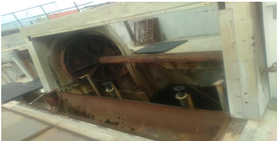
Figure V.02 : Un filtre rotatif hors service (état actuel). [Propre photo]
