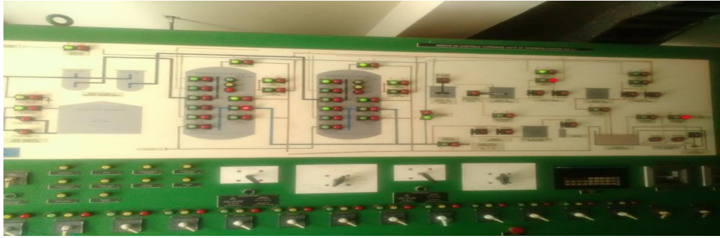
Figure IV.12 :L'armoire de commande de l'installation. [Propre Photo]
