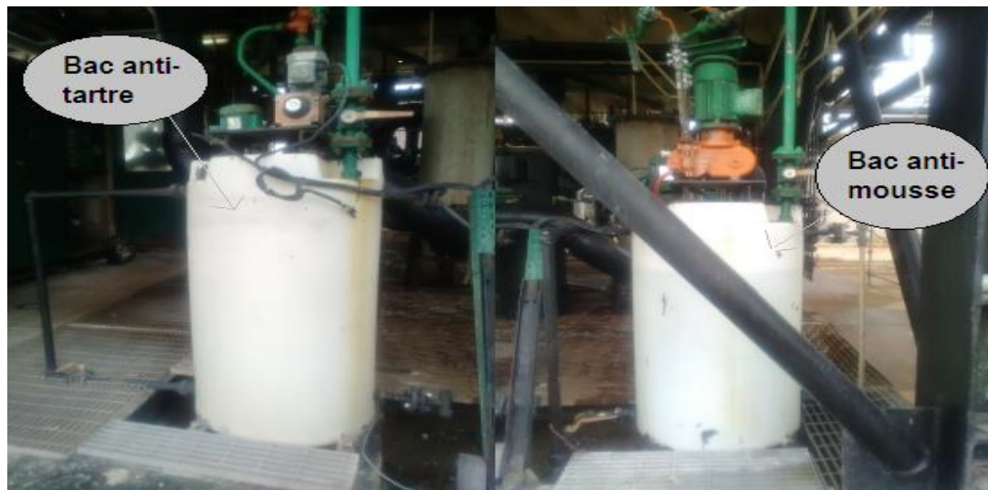
Figure IV.11 : Station de dosage chimique. [Propre Photo]
