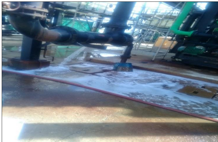
Figure V.07 : Fuite de saumure à la sortie des unités de dessalements. [Propre photo]
