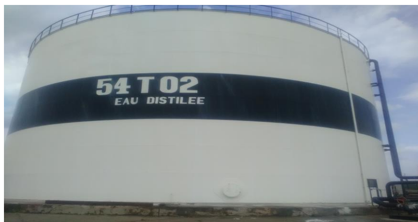
Figure .IV.13. Le Bac de stockage d'eau distillé. [Propre Photo]
