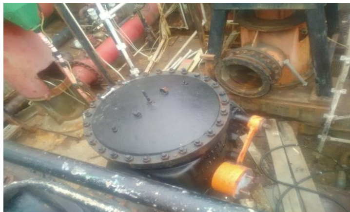
Figure V.03 : Une pompe en panne (état actuel). [Propre photo]
