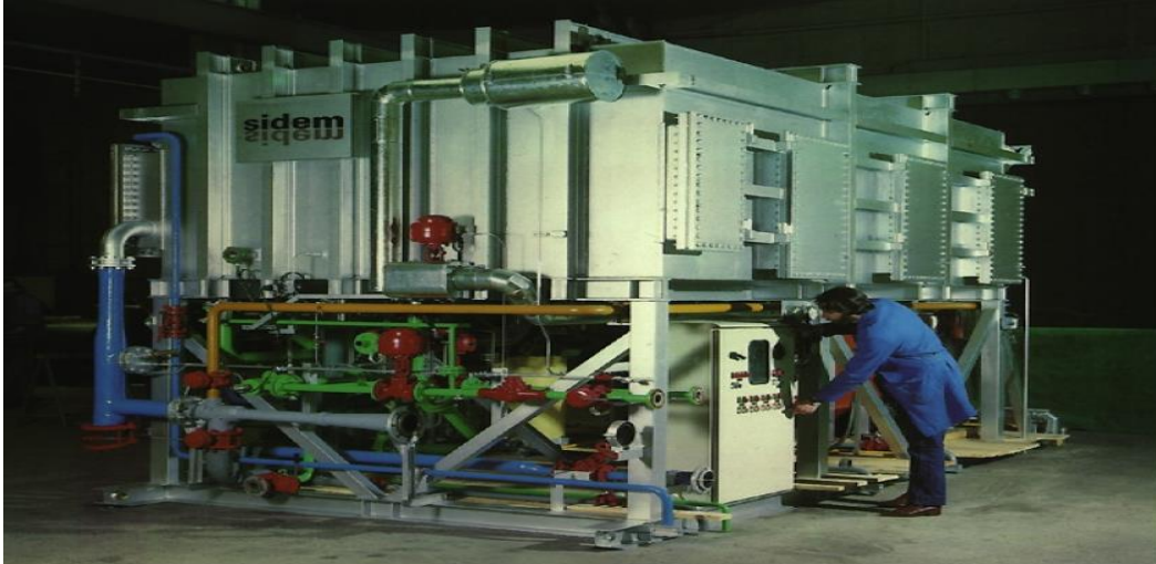
Figure III.02 : Unité de dessalement SIDEM a thermocompression 200 m 3 /jour. [25]
