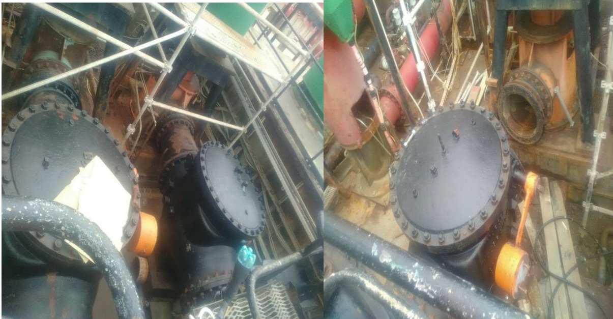
Figure IV.09 : les pompes d'eau de mer. [Propre Photo]
