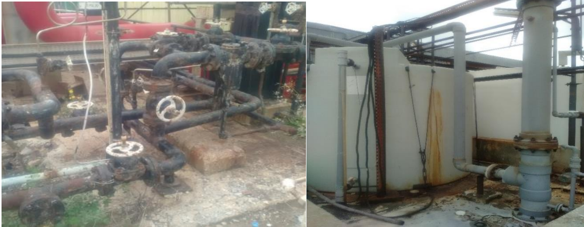
Figure V.06 : Quelques signes de corrosion au niveau de la station. [Propre photo]
