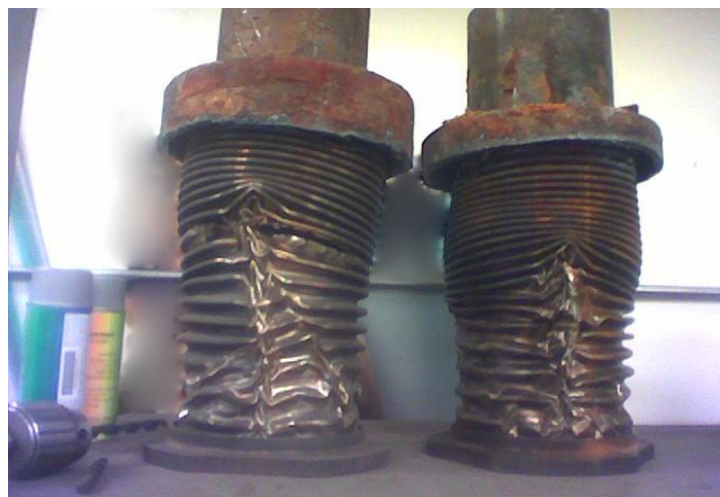
Figure VI.1 : Joint de dilatation détruit par un coup de bélier
