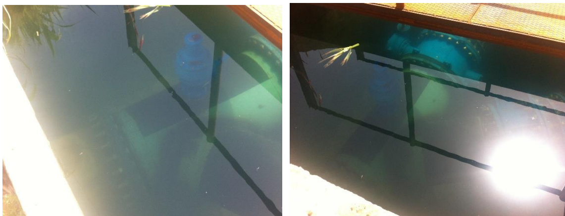
Figure II.11 : fuite au niveau de la vanne d'arrivée(H.DJIDI.2016)
