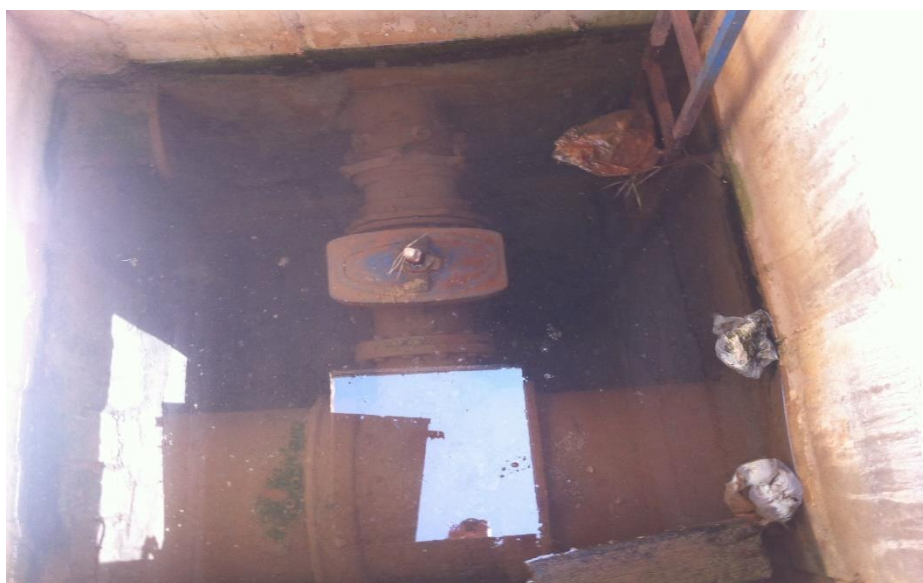
Figure II.8 : fuite au niveau de la vanne de distribution (H.DJJIDI.2016)
