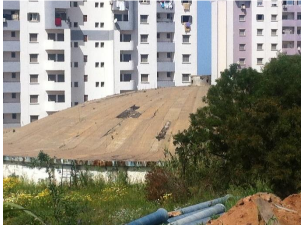
Figure II.9 : Réservoir de production (H.DJIDI.2016)
