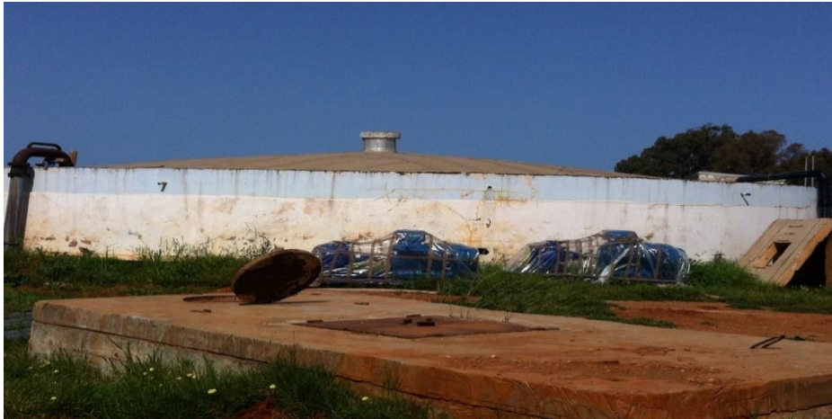
Figure II.6 : Réservoir 3000 m 3 (H.DJIDI.2016)
