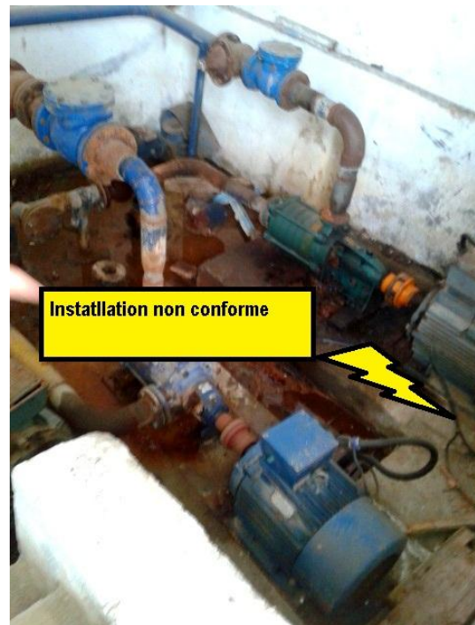
Figure (III.04): Etat des pompes de la station de reprise (Imechattane).
