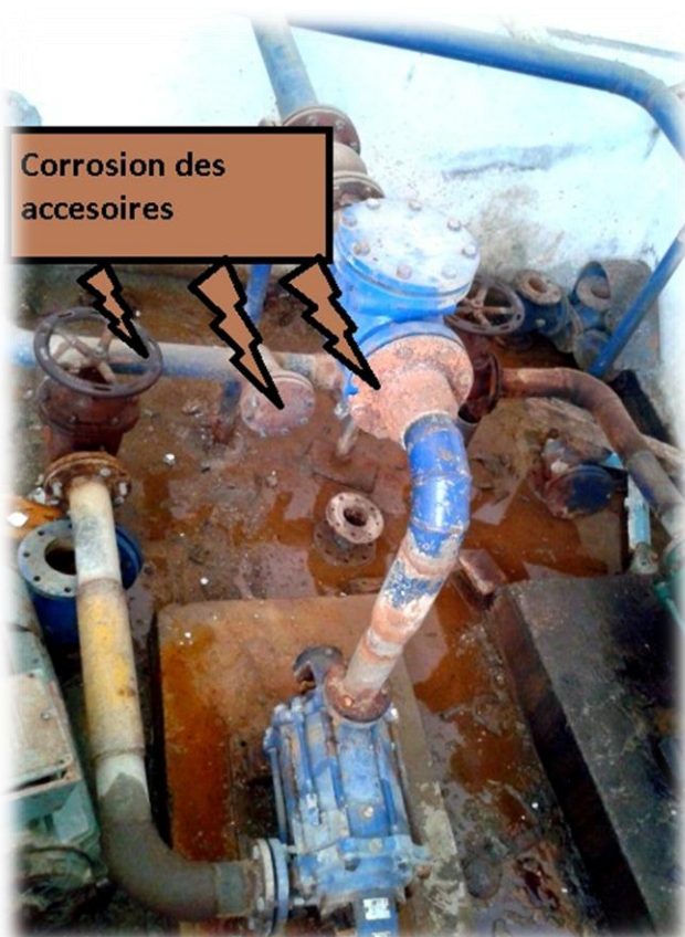
Figure (III.01): Etat des pompes de la station de pompage (SP1).
