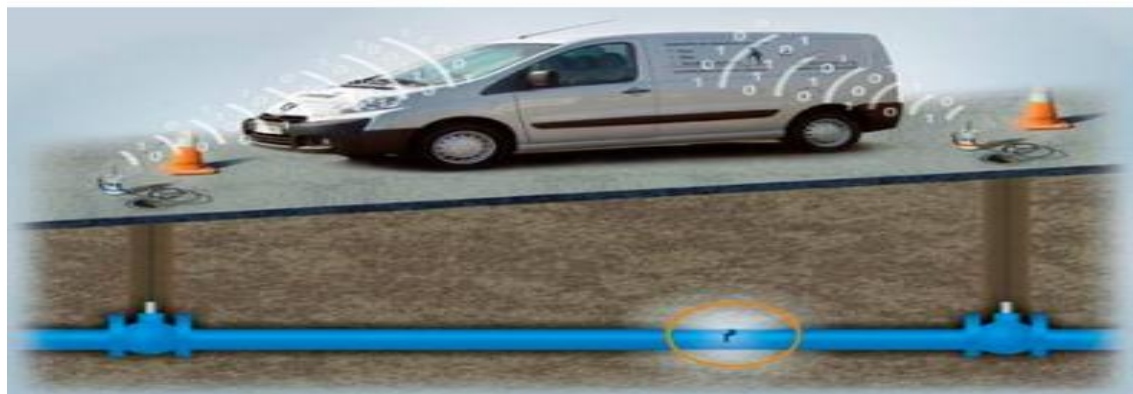
Figure VIII .2 : Détermination des fuites par corrélateur acoustique
