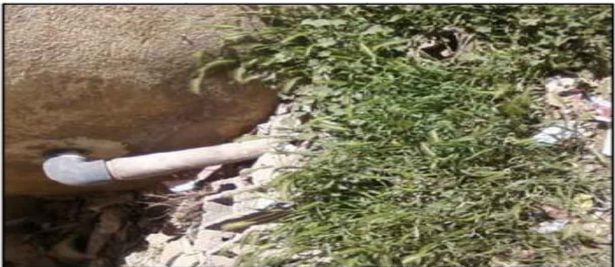
Figure III.05 : Conduite de vidange du réservoir
