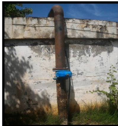
Figure IV.8 : Conduite d'arrivée d'eau de réservoir R1000 BOURKIKI en acier.
