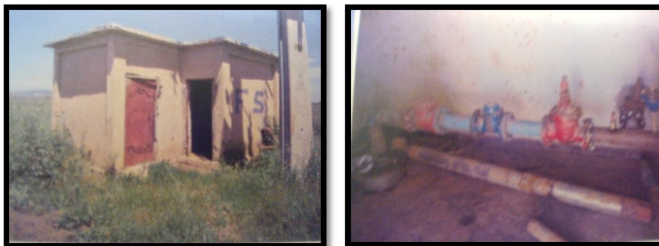
Figure IV.5 : Vue du forage F5 : Ses équipements et son abri.
