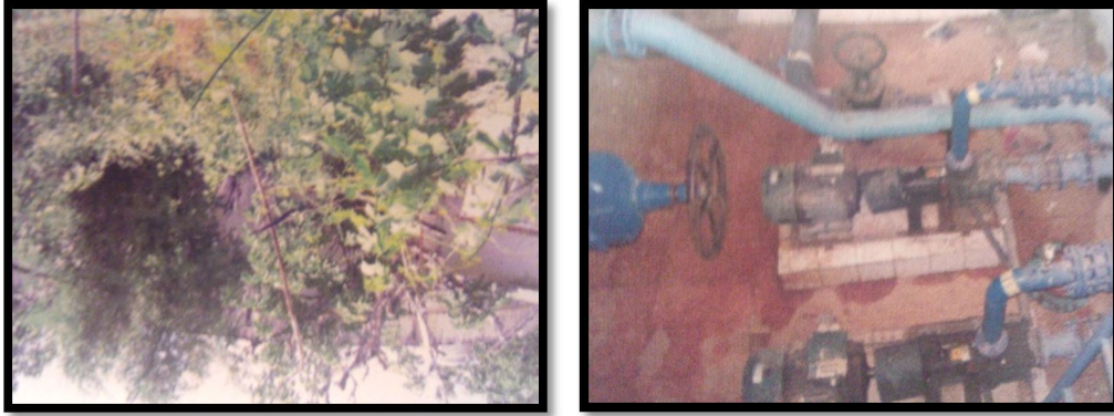
Figure IV.6 : Vue du réservoir R1000 m 3 et équipements de la chambre de vannage.
