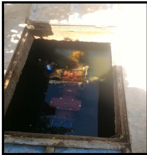
Figure IV.7 : Contrôleur de niveau d'eau de réservoir R1000 BOURKIKI.
