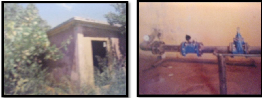
Figure IV.4 : Vue du forage F4 : Ses équipements et son abri.
