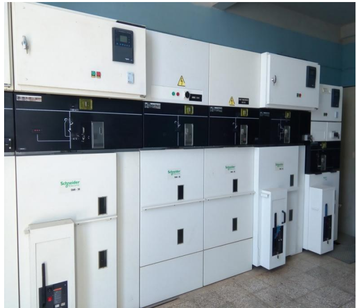
Figure VII.3 : une armoire électrique.
