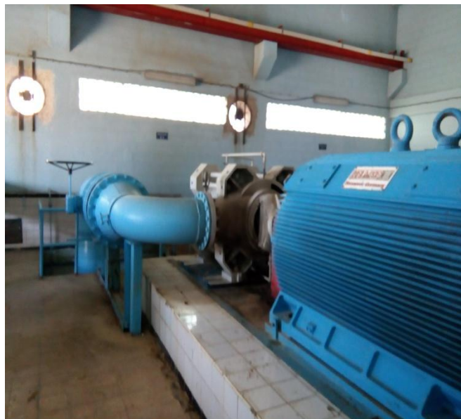
Figure VII.2: les équipements hydrauliques.
