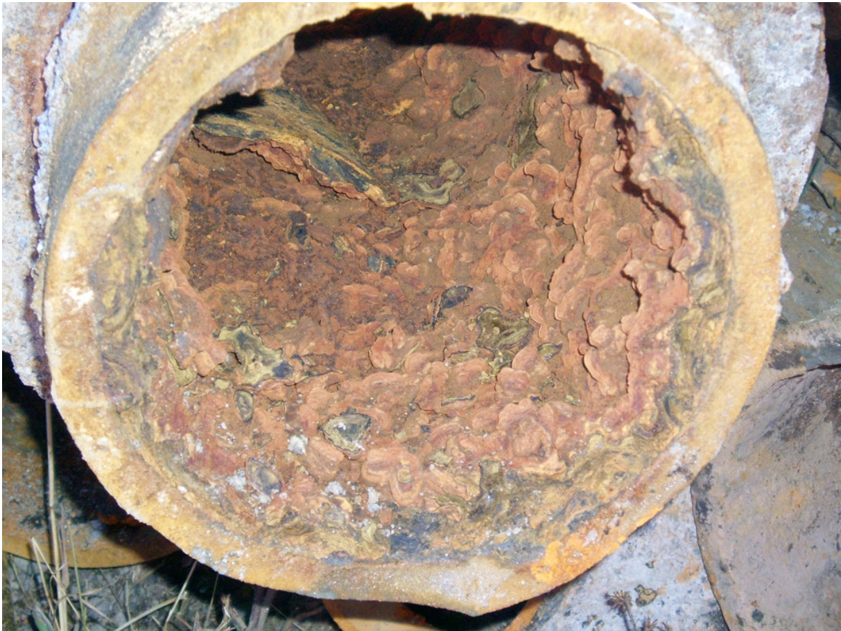
Figure VI.8: Corrosion interne dans une conduite.
