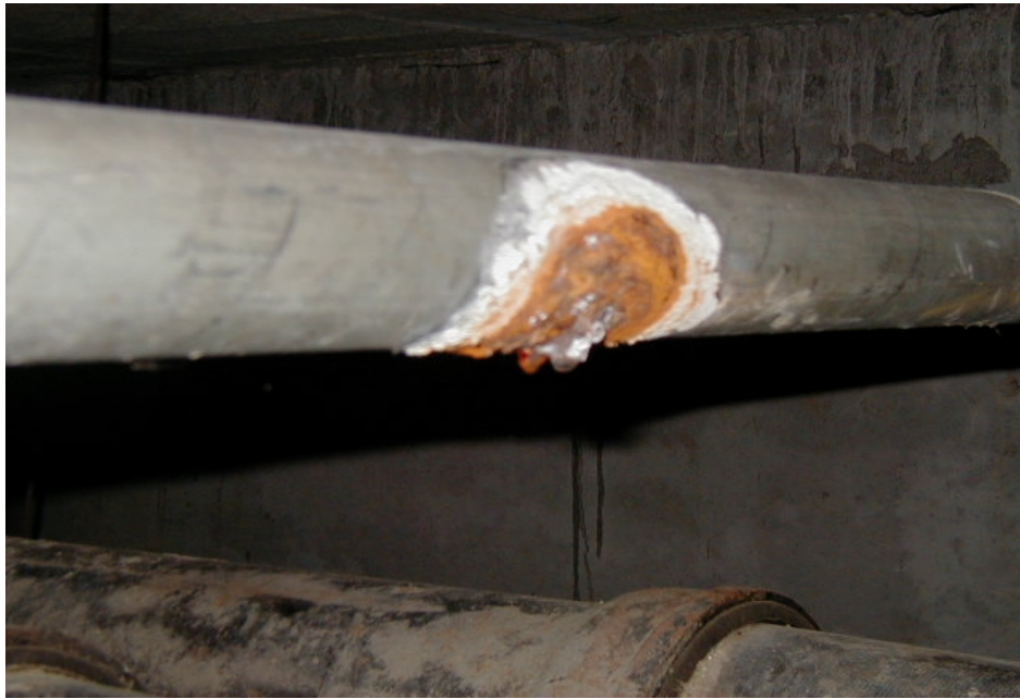
Figure VI.7: Corrosion externe dans une conduite.
