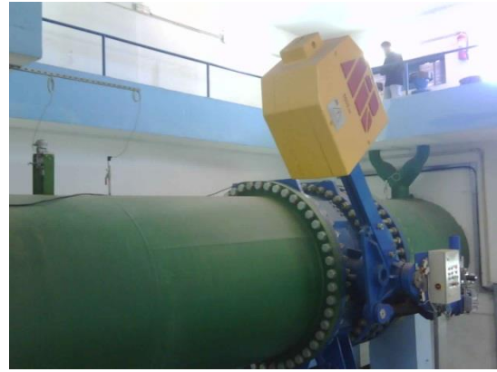
Vanne installée dans la conduite MAO
