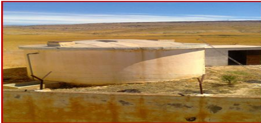
Figure I.6. Réservoir existant 250 m 3
