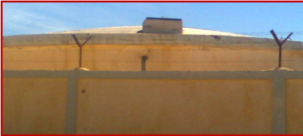
Figure I.5. Réservoir existant 100 m 3
