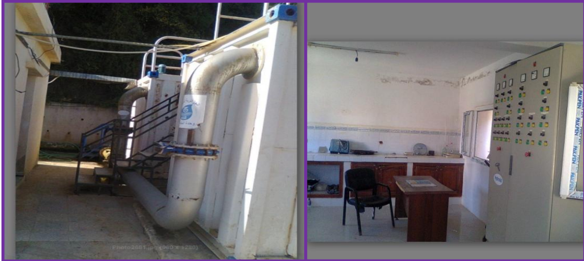
Figure I.3 : Vue sur la station de traitement (monobloc) de Sidi Aissa
