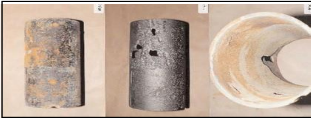
Figure IV. 1 : Corrosion des conduites métallique.
