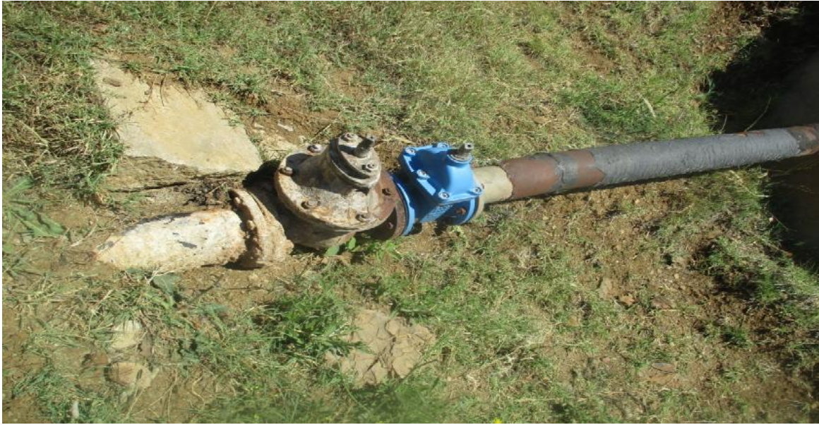
Figure3.10 :Vanne de conduite d adduction sans regards
