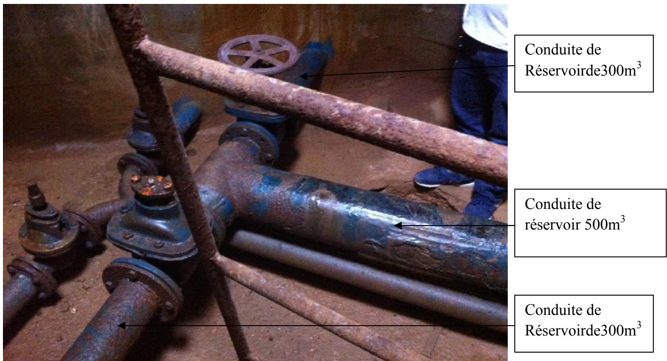
Figure 3.4 : La chambre de vanne
