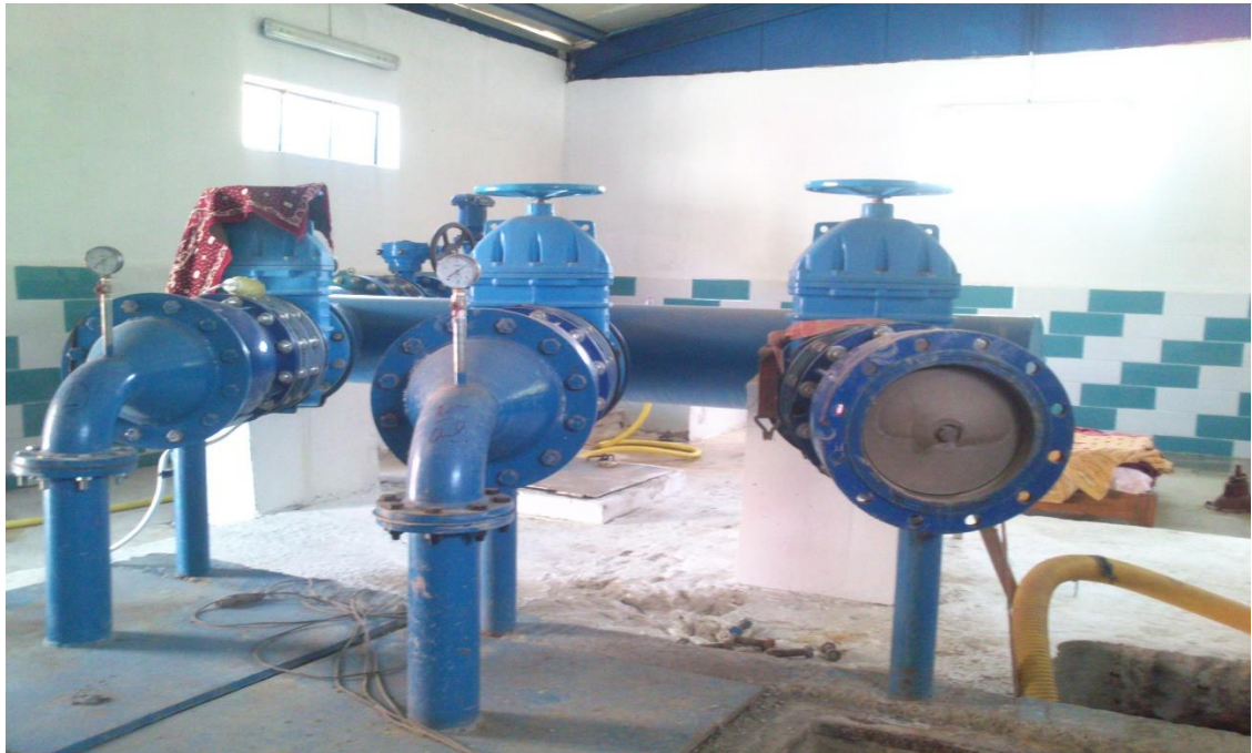
Figure VI- 3 Photo de la station de pompage de Magtaa Lazrag
