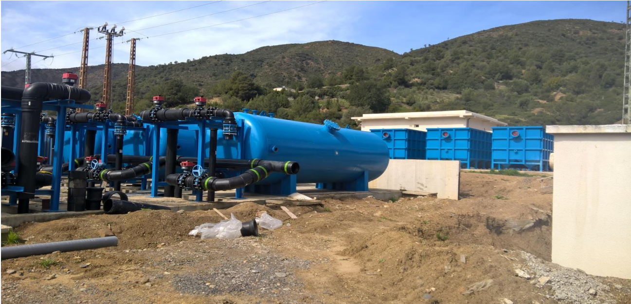
Figure III- 3 Photo de la station de traitement monobloc
