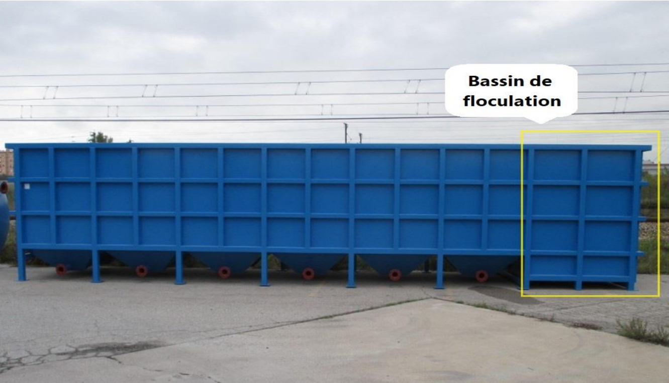
Figure III- 5 Photo du bassin de floculation et décantation
