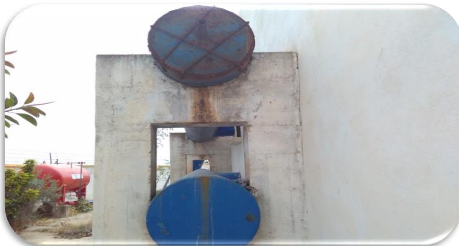
Figure IV.7 : Vue à l'extérieur de la chambre des pompes (la conduite DN700 mm) (DRE Annaba, Mars 2018)
