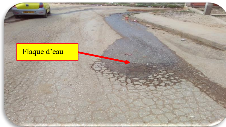
Figure IV.23 : photo de fuite sur la conduite de distribution DN 160 mm en PVC (DRE Annaba, Mars 2018)
