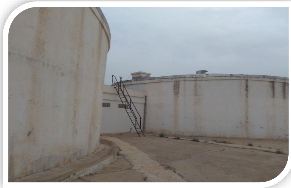
Figure III -2 : Réservoir Bussedra 2*2500 m3 (DRE Annaba, Mars 2018)
