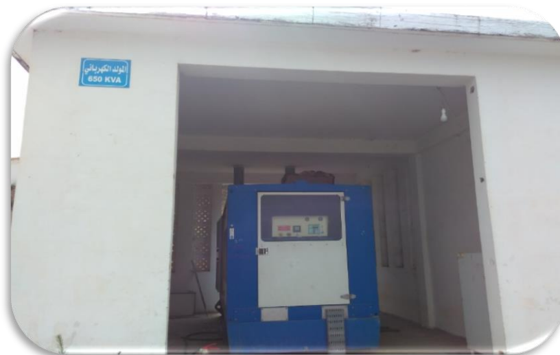
Figure IV.11 : Vue à l'extérieur de groupe électrogène de la station de pompage Bousseadra (DRE Annaba, Mars 2018)
