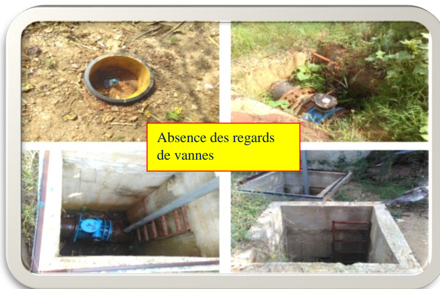
Figure IV.18 : vannes du réservoir 2*2000 m3 (DRE Annaba, Mars 2018)
