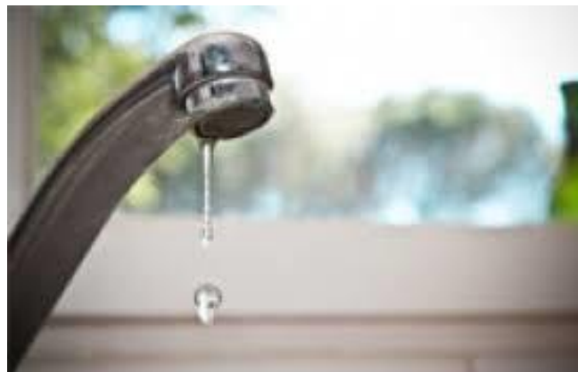
Figure VI.2 : perte d'eau sur robinet
