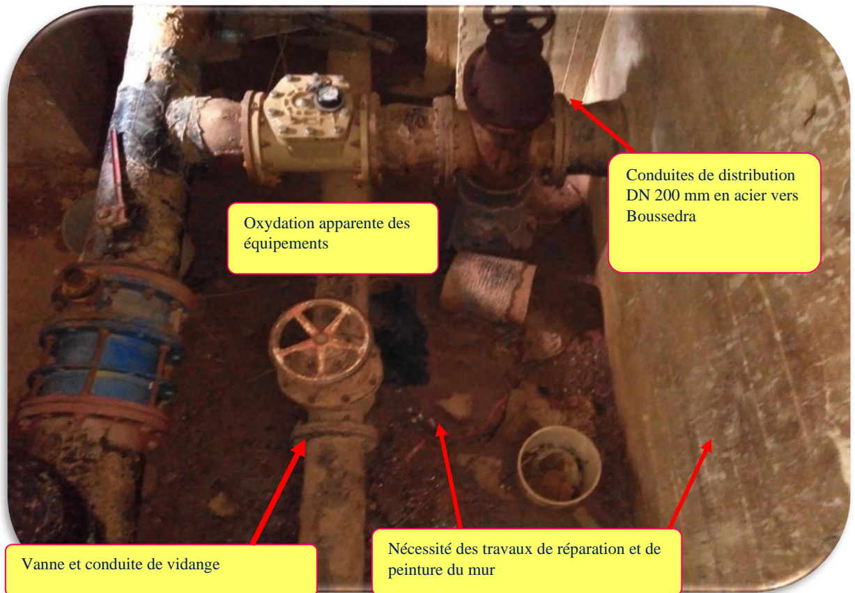
Figure IV.21 : photo à l'intérieur de la chambre des vannes du réservoir El-Bouni 2*2000 m 3 (DRE Annaba, Mars 2018)
