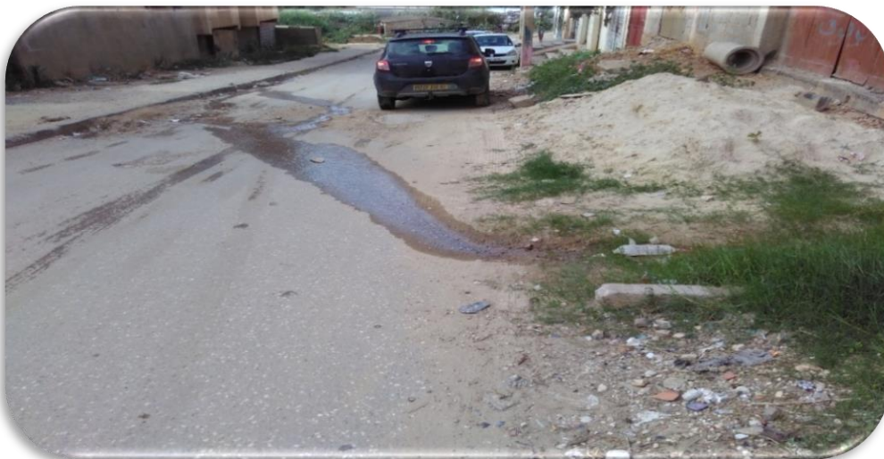
Figure IV.25 : fuite à cote de la conduite de distribution DN 60 mm (DRE Annaba, Mars 2018)
