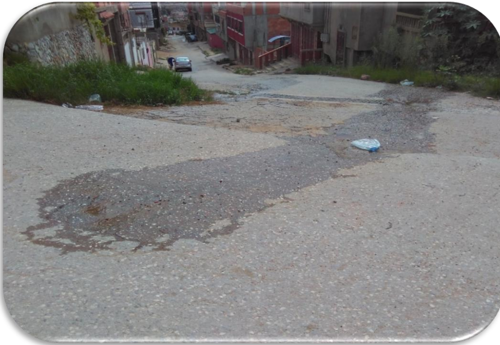
Figure IV.26 : photo d'une fuite sur la conduite de distribution DN 60 mm en PVC (DRE Annaba, Mars 2018)
