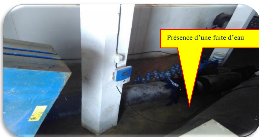
Figure IV.15 : Vue à l'intérieure de la chambre des vannes. (DRE Annaba, Mars 2018)
