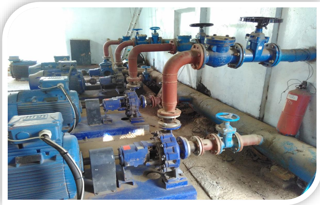
Figure III -4 : Station de pompage ADE El-Bouni (DRE Annaba, Mars 2018)
