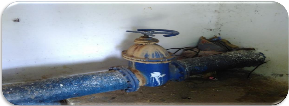
Figure IV.19 : Vue à l'intérieure de la chambre de vannes du réservoir 2*2000 m 3 .
