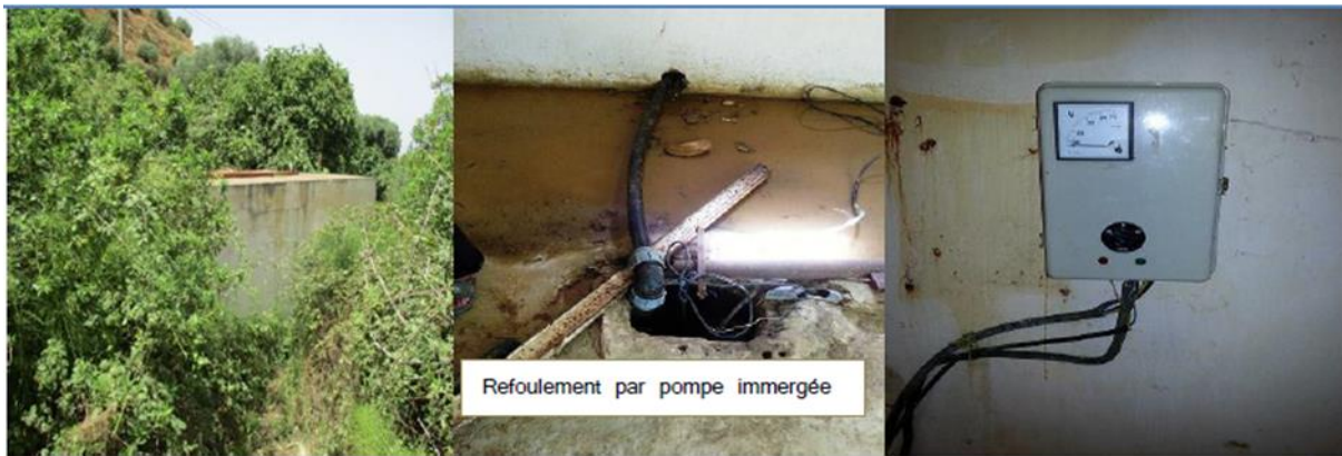
Figure I. 6 : station de pompage (en 2015)
