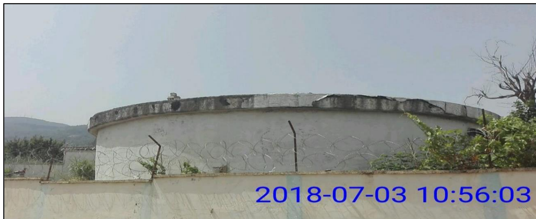
Figure (III.9) : Vue extérieure de réservoir semi enterré RV1000 m 3 . [4]
