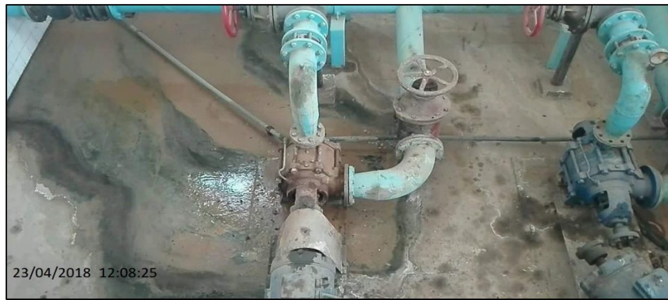
Figure (IV.4) : Vue intérieure des éléments de la station de pompage. [4]
