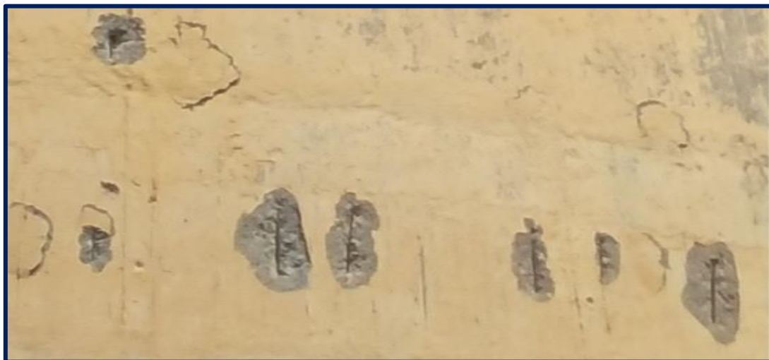
Figure III .4 fissuration du réservoir de BRISONNIER
