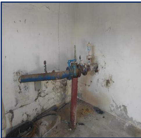
Figure III.2 : forage F2 (Manque de manomètre)
