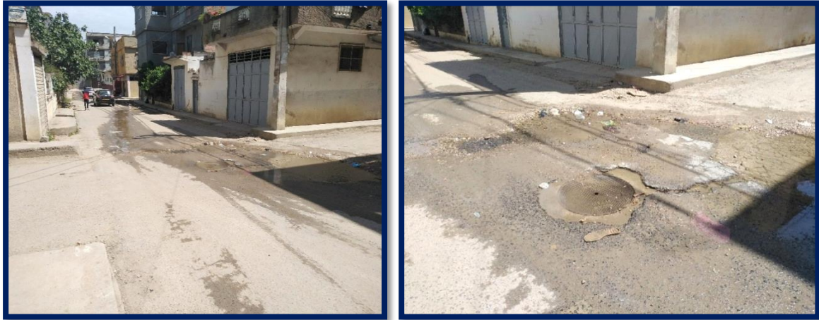
Figure III.5 ET III.6 : Fuite sur une conduite DN125-AC au niveau du lotissement Mahi
