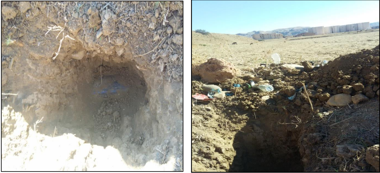
Figure III.16 : Conduite de PEHD 160mm de diamètre et de 3 155 ml de longueur, reliant la station de pompage SP KRIMA à Chambre des vannes 02. En mauvaise état.
