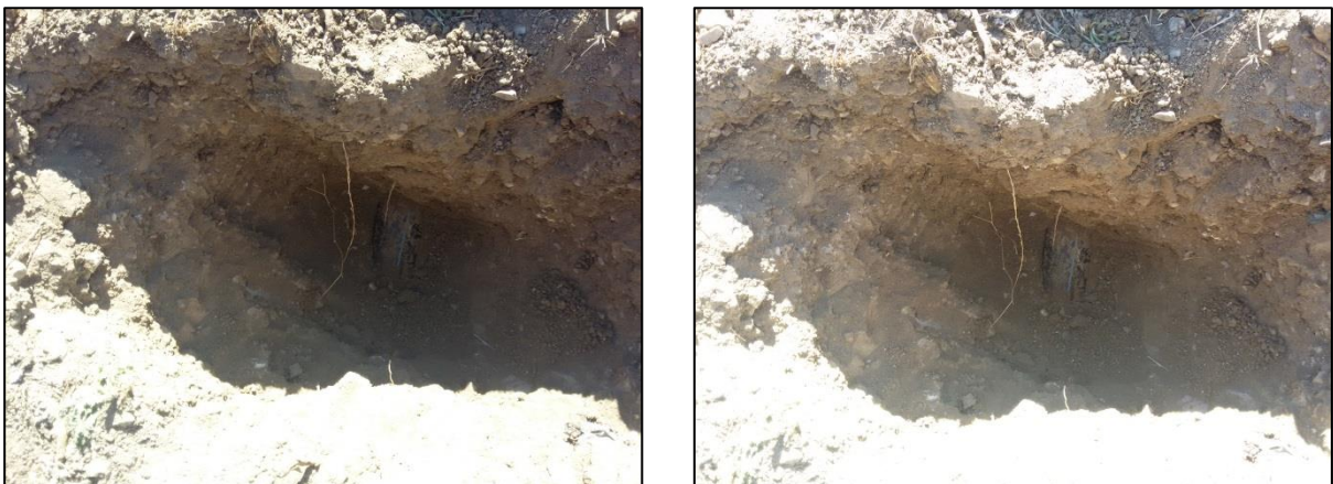
Figure III.17 : Conduite d'adduction vers R200, PEHD de 110mm de diamètre et de 636 ml de longueur. En mauvaise état.
