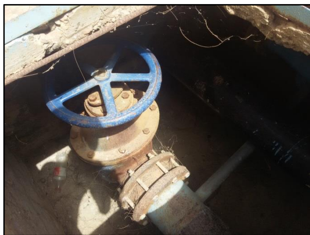
Figure III.3 : Chambre de vanne 01.
