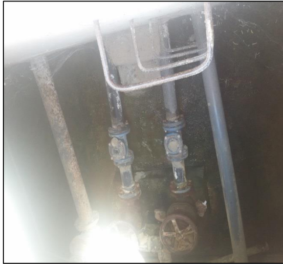
Figure III.32 : Les vannes de distribution R50.
