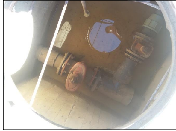
Figure III.30 : Chambre de vanne03. En bonne état
