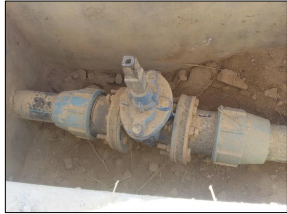
Figure III.28 Vannes de distribution R200 vers nœud N72. En bonne état.
