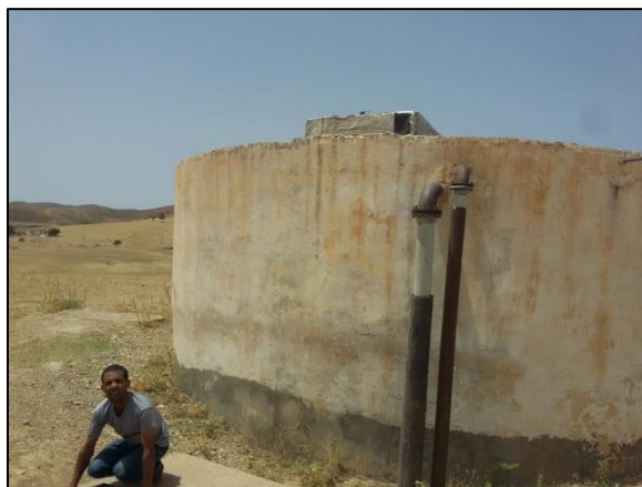
Figure III.11 : Réservoir R200 avec un mur fissuré qui engendre des fuites. et manque mur de clôture
