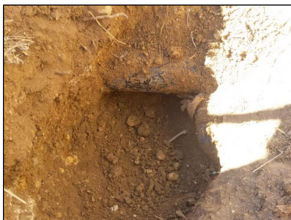
Figure III.19 : Conduite de distribution de 160mm de diamètre, R200, vers nœud N1. En bonne état.
