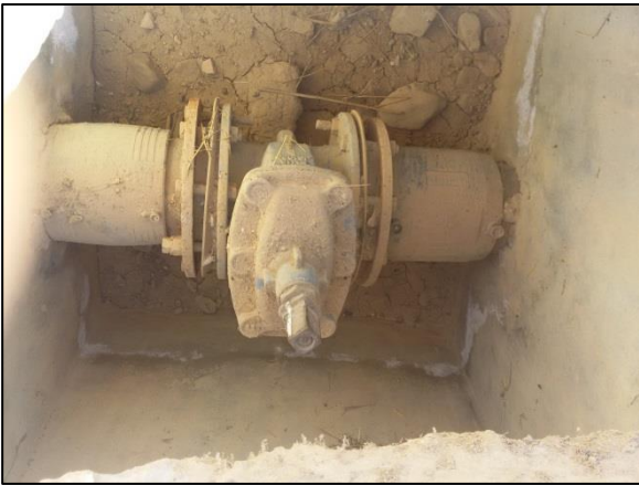
Figure III.29 : Vannes de distribution R200 , vers nœud N1 En bonne état.
