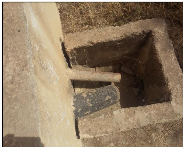
Figure III.4 : Réservoir d'eau brut.
