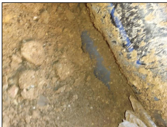
Figure III.20 : Conduite d'arrivée PVC110 R200 En mauvaise état.
