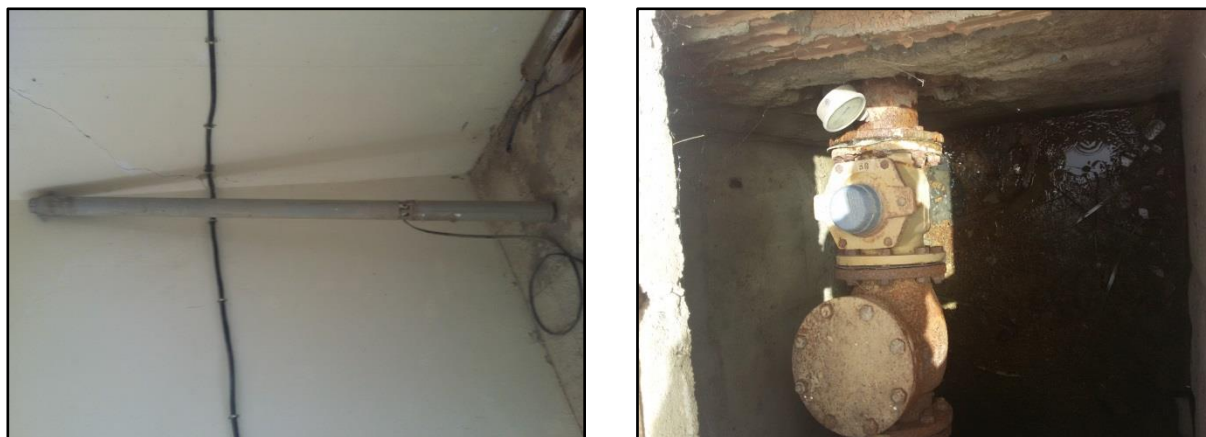
Figure III.10 : Station de pompage SP KRIMA. Manque mur de clôture
