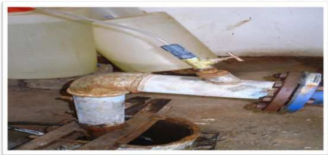
Figure I.5 Equipements détérioré F06 -Source : BEHG – 2010.
