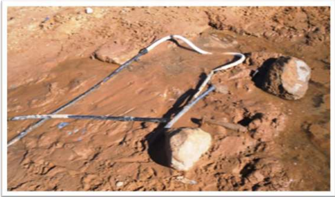
Figure I.10 : Existence d'une fuite dans le réseau -Source : BEHG - 2010.
