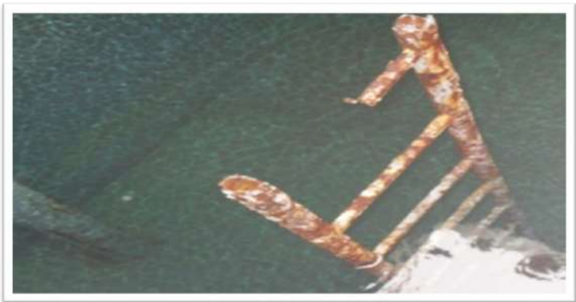
Figure I.7 : Etat des équipements à l'intérieur du réservoir (Corrosion avancé de l'échelle R01) Source : BEHG -2010.
