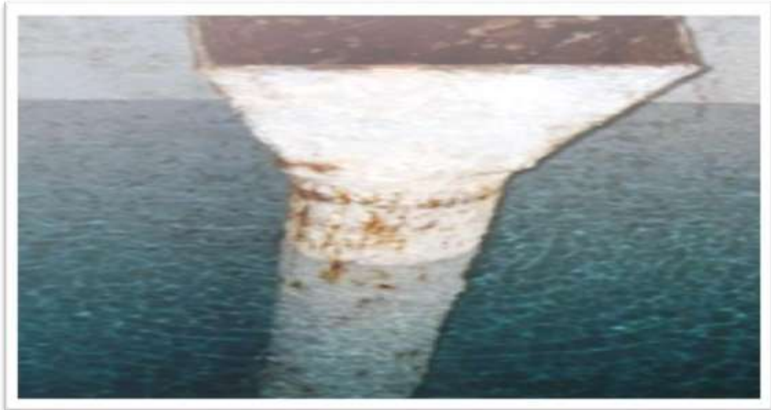
Figure I.6 : Etat des équipements à l'intérieur du réservoir (Corrosion du collecteur trop plein R01) - Source : BEHG – 2010.
