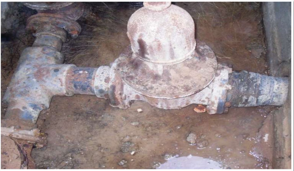
Figure I.8: Réparation des fuites avec des moyens non conforme (chambre à air) Source : BEHG – 2010.
