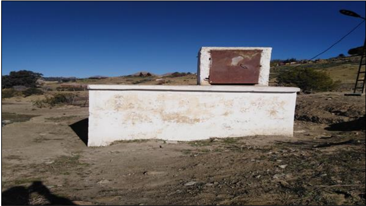
Figure IV.2 : Photo de l'extérieur (postérieure) de la bache plus la station de pompage
