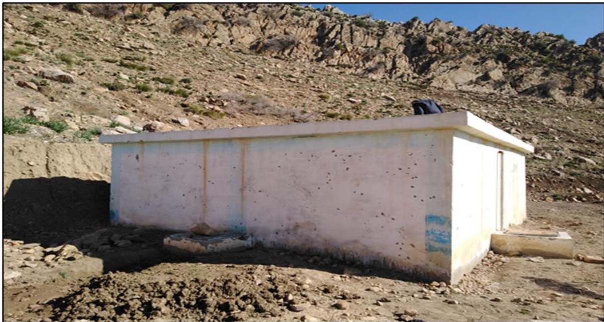
Figure IV. 12 : l'extérieur de la bache de 50 m 3
