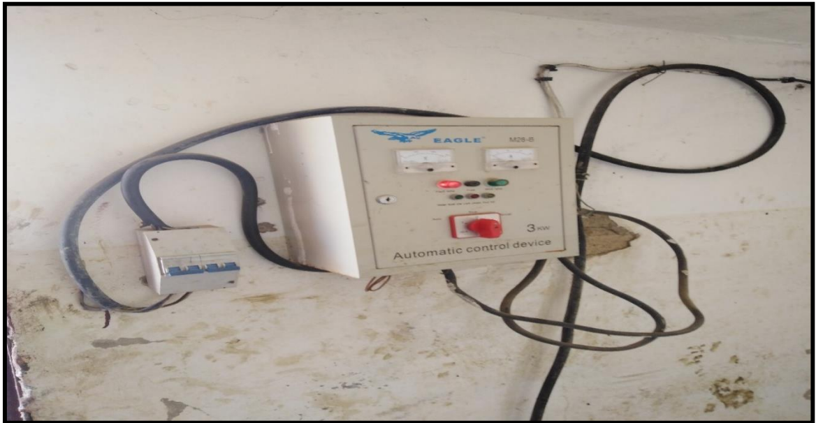
Figure IV. 6 : photo du disjoncteur et l'automate de démarrage des pompes immergées (BET.Tissemsilt) (13.01.2021)
