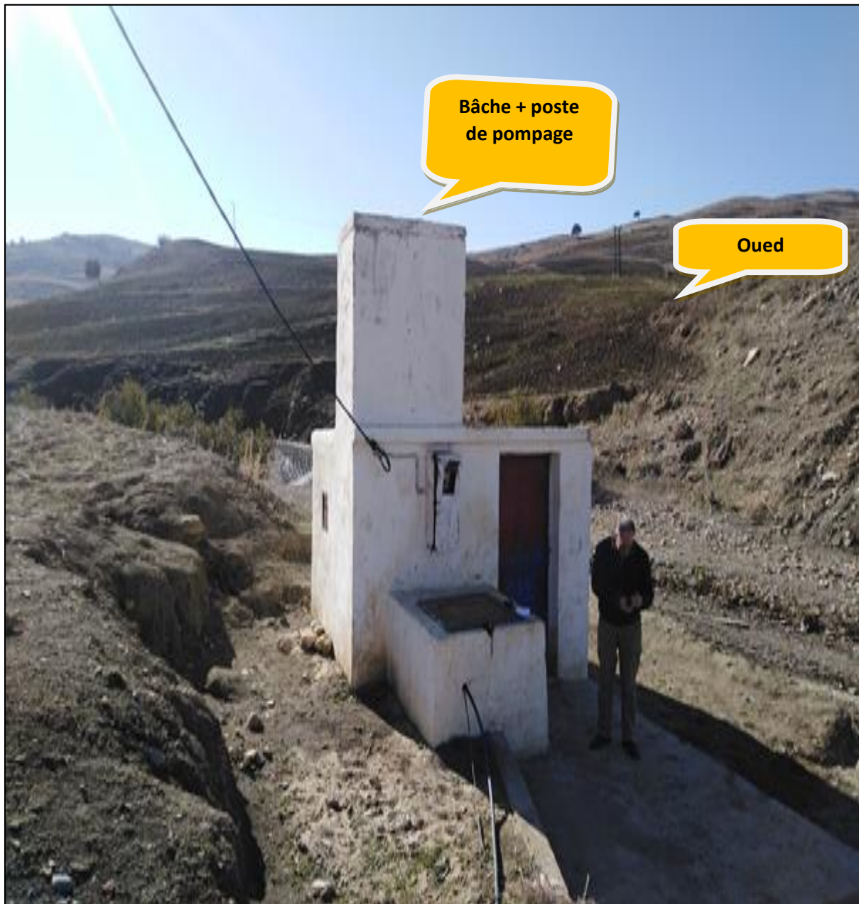
Figure IV.1: Photo de l'extérieur de la bâche plus la station de pompage d'AIN KERCHA
