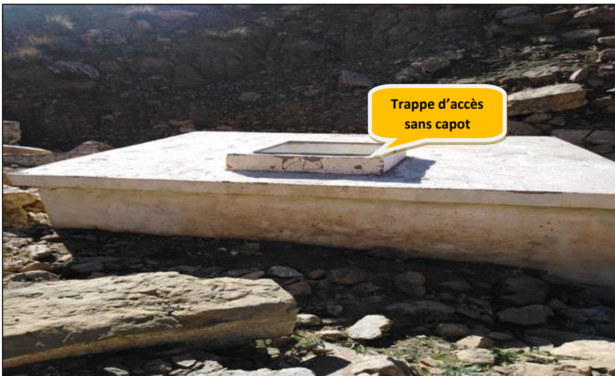
Figure IV.8 : Photo de l'extérieur du captage d'AIN TAGHIA (BET.Tissemsilt) (13.01.2021)
