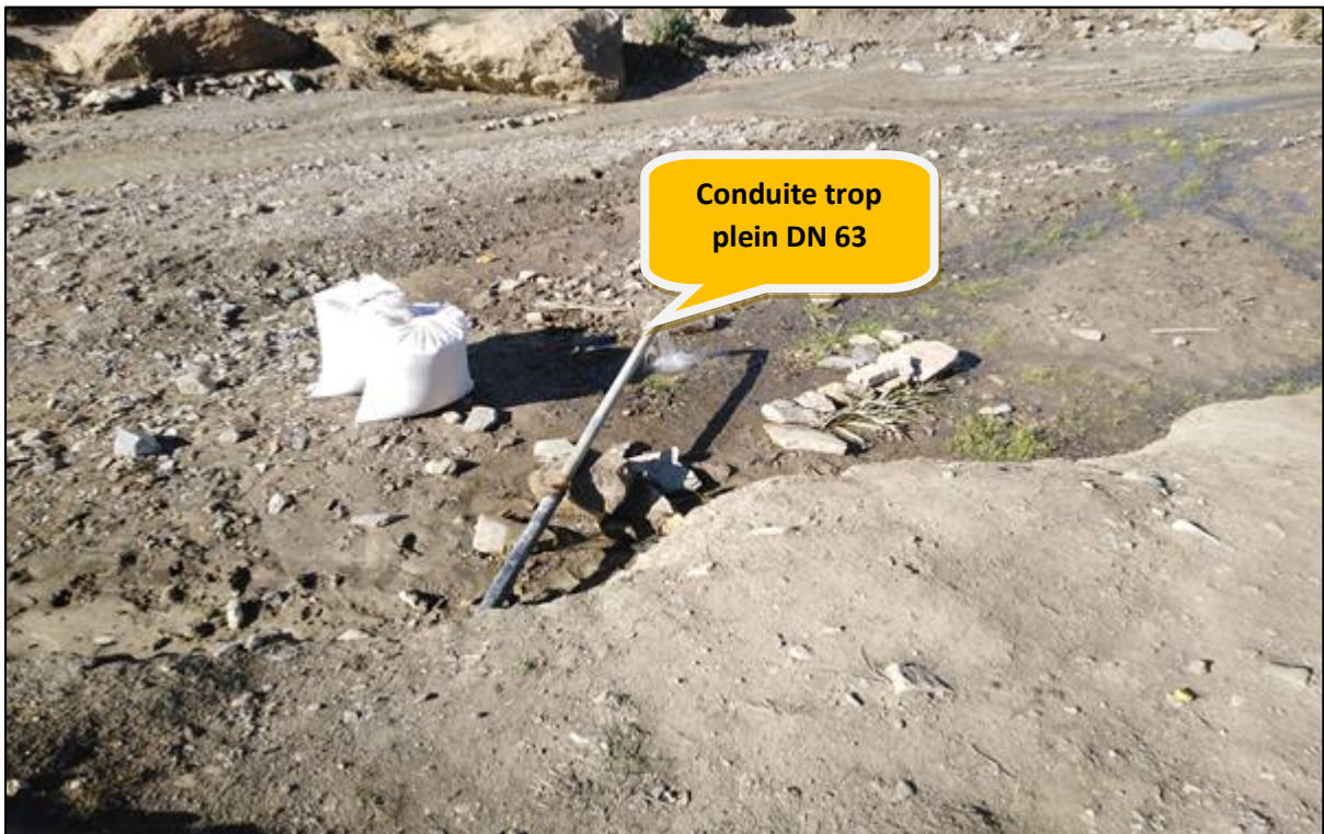
Figure IV.3 : Etat actuel de la Conduite du trop-plein de la bache de la station (Source :BET.Tissemsilt) (13.01.2021)
