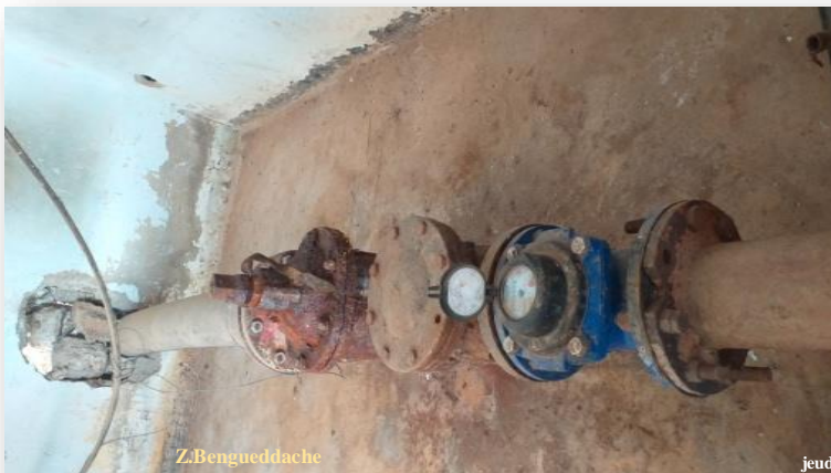
C. La conduite de refoulement a l'intérieur de l'abri de forage
