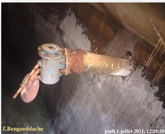
C. conduite de trop plein
