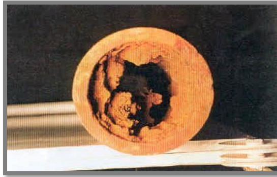
Figure N° II.1 Conduite de diamètre 80mm ayant subi des dépôts ferriques de corrosion interne Source: [DRE Relizane]
