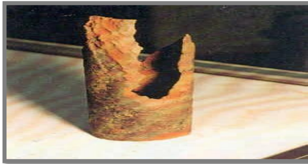
Figure N° II.3 Conduite ayant subi une rupture
