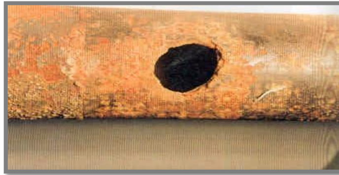
Figure N° II.2 : Conduite de diamètre 80 mm ayant subi une corrosion externe localisée (courants vagabonds, hétérogénéité du sol, ...) source [DRE Relizane]
