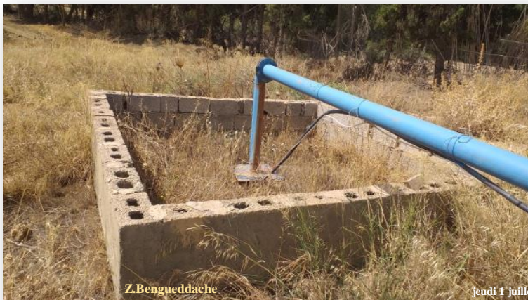
D. le forage Oued Djidiouia
