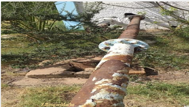
D. La conduite de refoulement
