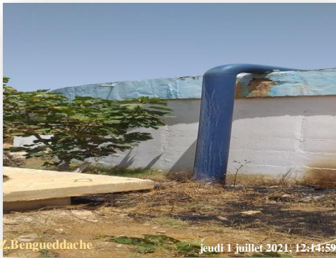
B. La conduite d'arrivée
