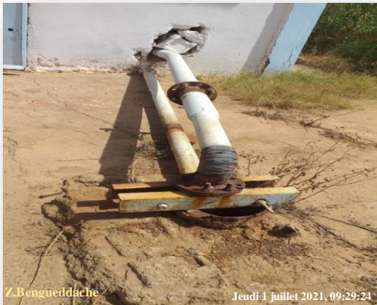
A. La conduite de refoulement a la sortie du
