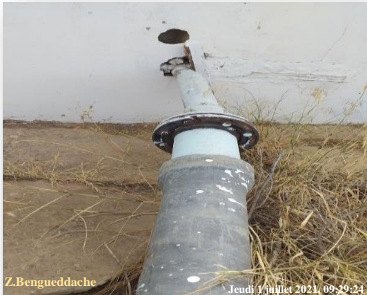
A. La conduite de refoulement
