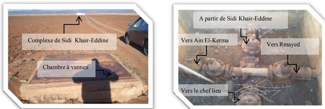
Figure I.10 : Regard des vannes de station de Sidi Khair-Eddine (à l'extérieur et à l'intérieur)
