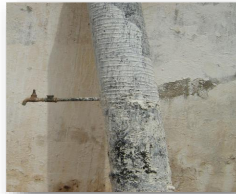
Figure IV.14 : Conduite d'arrivée au réservoir 500m 3 (DRE ain defla, 2021)
