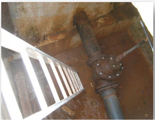
Figure IV.13 : Regard des vannes (le départ de réservoir). (DRE ain defla, 2021)
