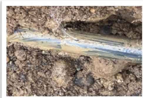
Fig III.2. conduite pehd en état de fuite classe PN10 (DRE 2021)
