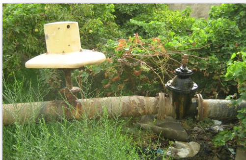
Figure III.10: Vanne et ventouse sur la conduite de refoulement(DRE Ain defla ,juin 2020)
