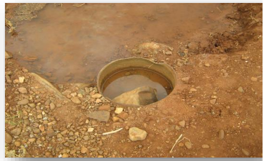
Figure.III.11: Ventouse sur la conduite d'adduction en état de fuite (DRE Ain defla ,juin 2020)
