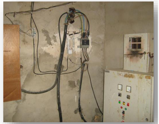
Figure III .9 : Armoire de commande de la pompe immerge(DRE Ain defla ,juin 2020)
