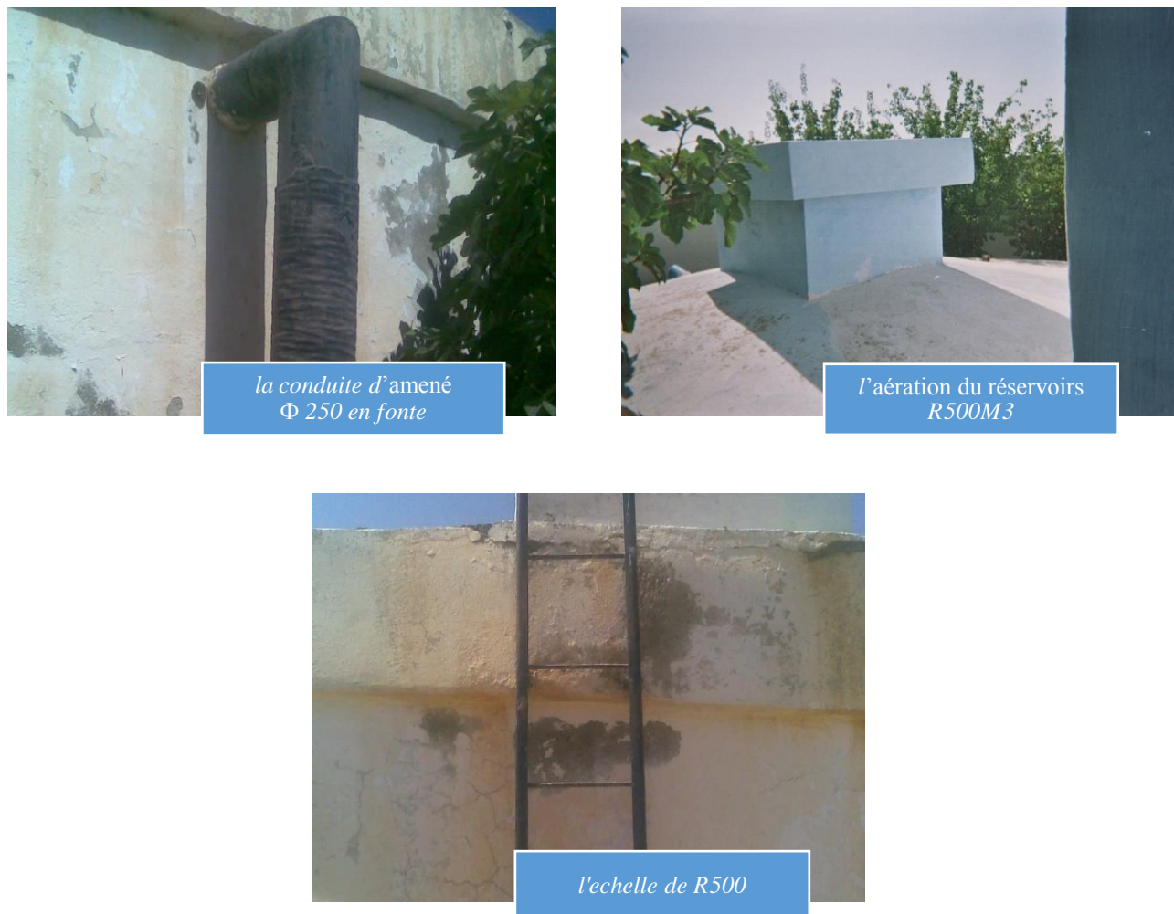
Figure IV.13: Réservoir R2 (500 m 3 ) (25/06/2021)
