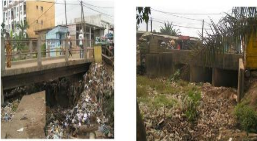
Figure II-4 : Dégradation des berges par l'intervention de l'homme
