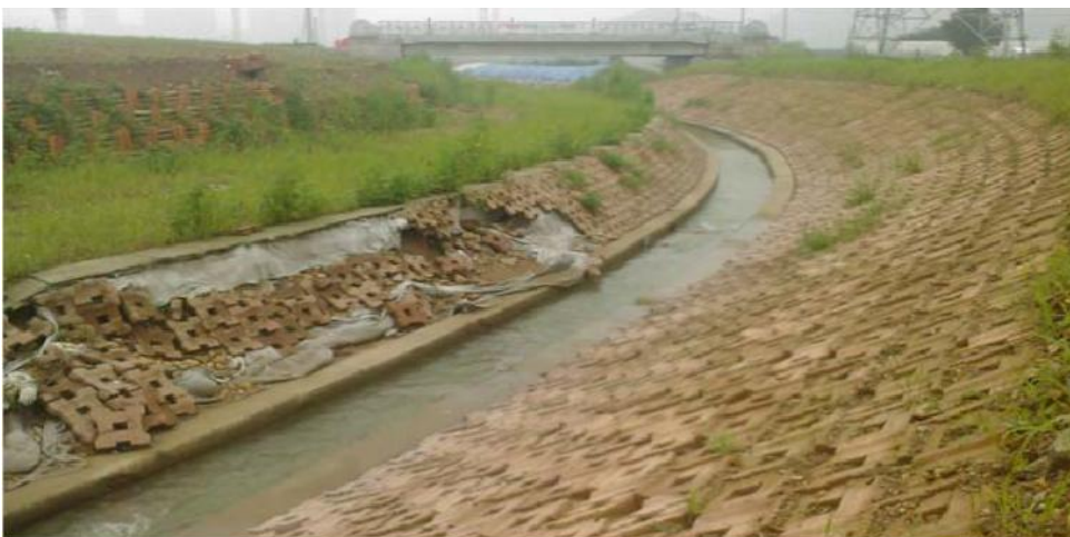
Figure III-11: dégâts du bloc en béton
