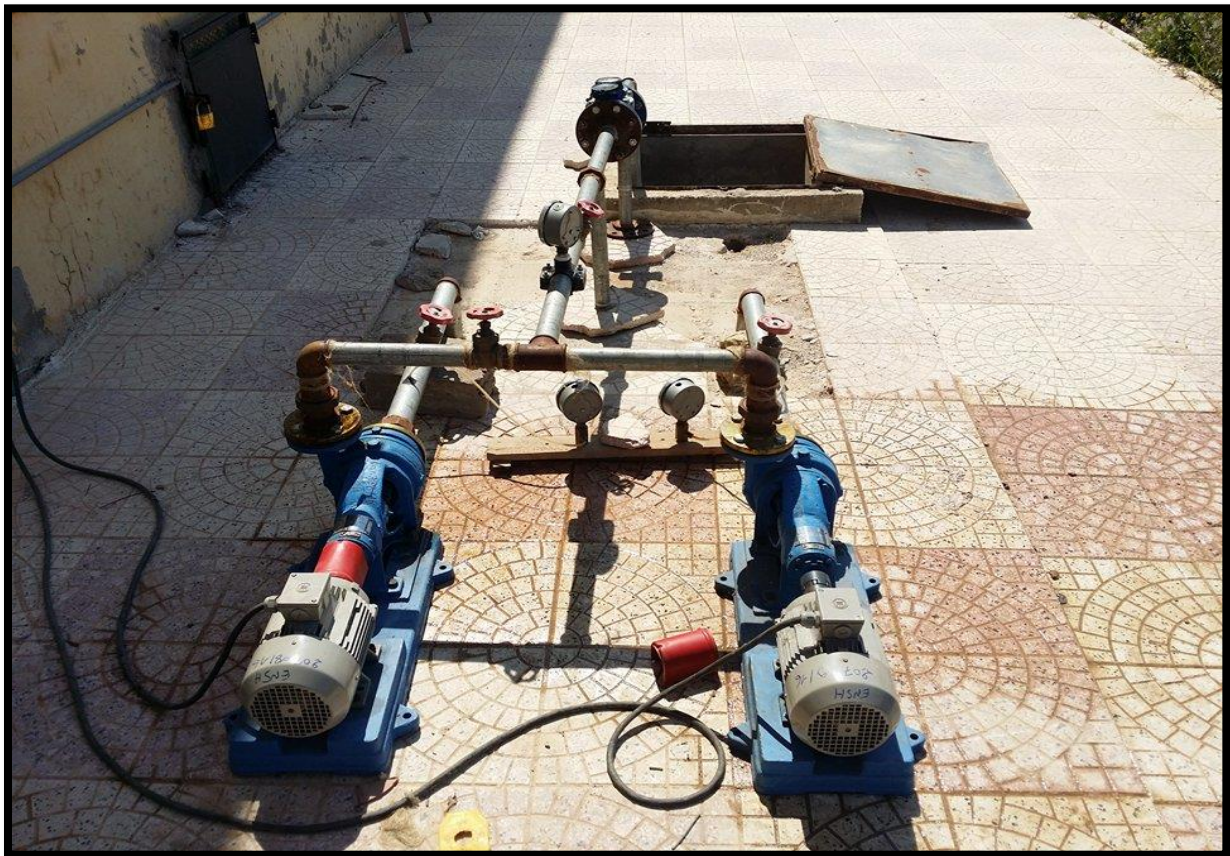
Figure III.3 : installation du banc d'essai avec les deux pompes identiques montées en parallèle.
