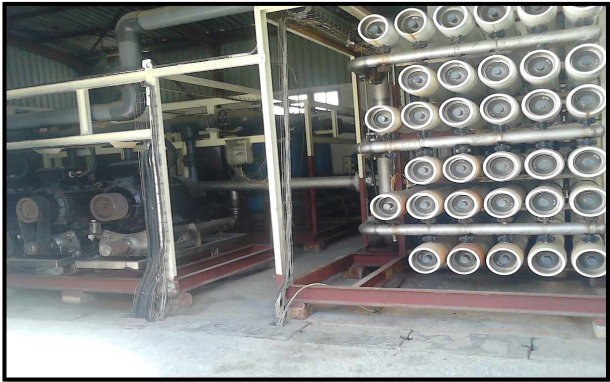
Figure I.8. Le couplage en parallèle des pompes à hautes pression et les osmoseurs
