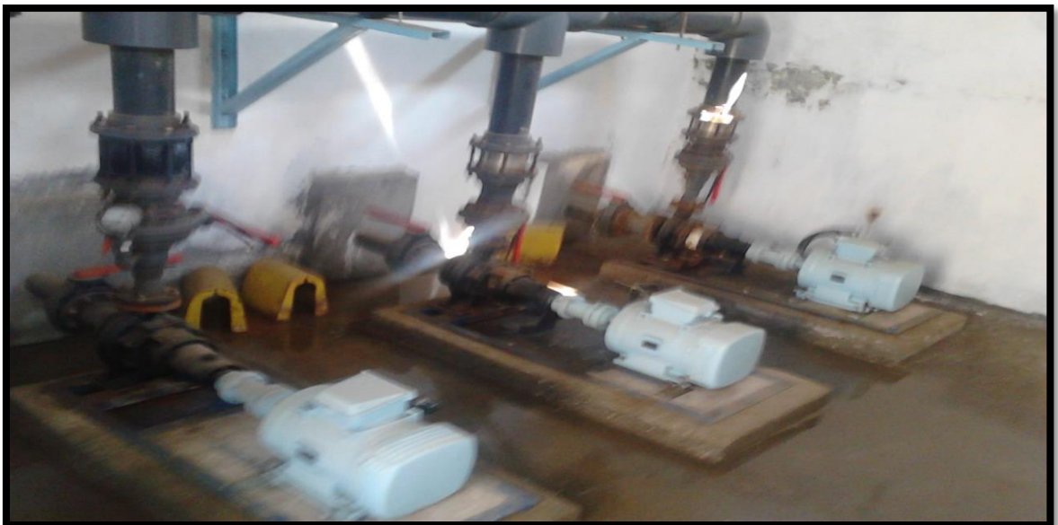
Figure I.7. Montage de trois pompes identiques en parallèle
