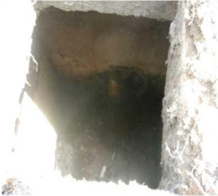
Figure I.6 : Regard en état dégradé (10/11 2016)
