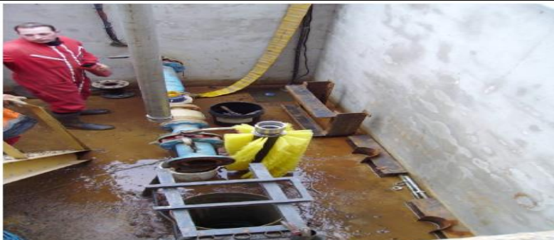
Figure III.10 : préparation du matériel pour le brossage mécanique et le curage air-lift (O. Dureau, 2007).
