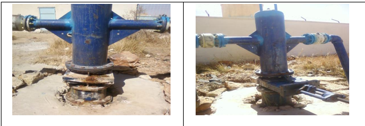
Figure IV.02 : Les équipements du forage de MERKSANE. (DRE Illizi).
