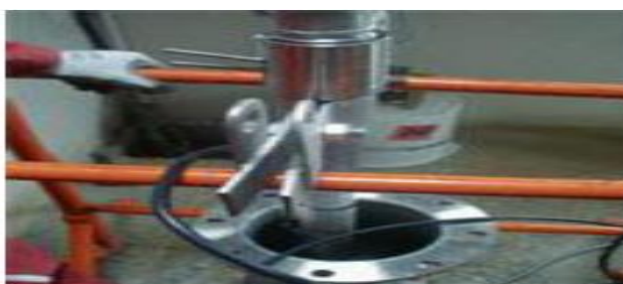
Figure III.16 : Remise en place d'une colonne inox à raccords rapides.
