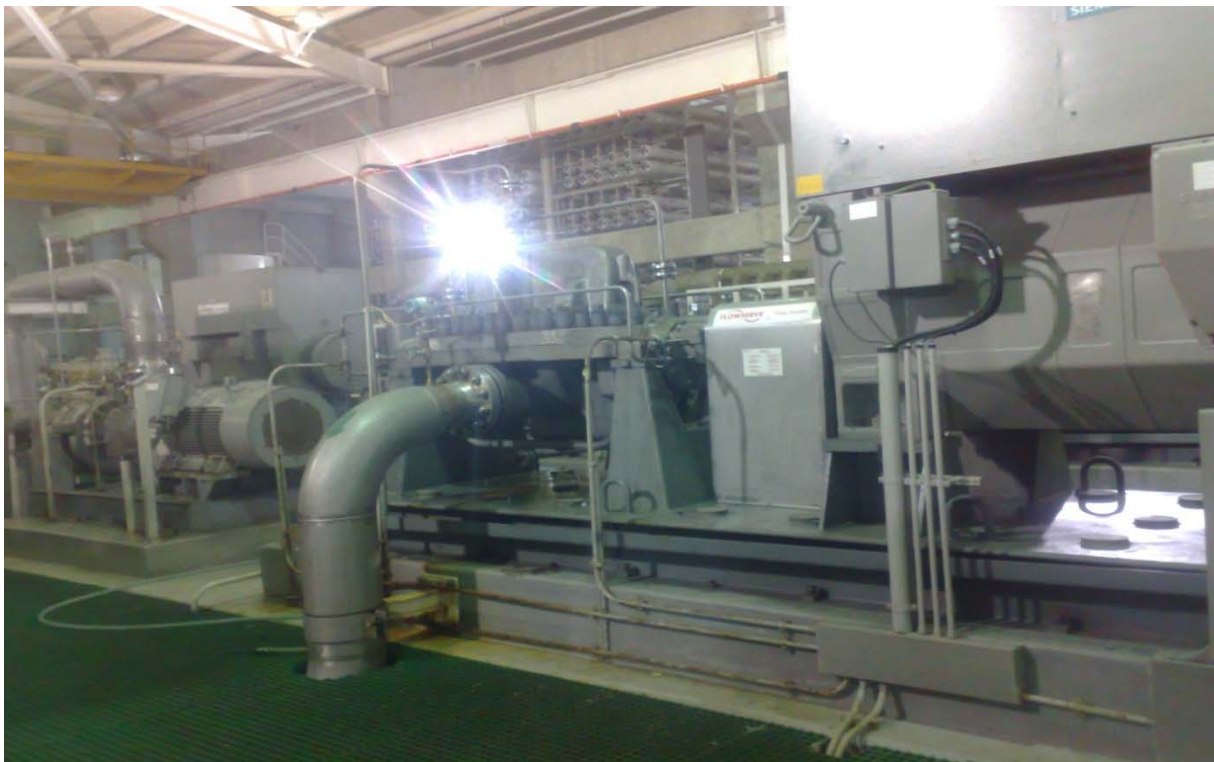
Figure III.01 : La pompe haute pression au niveau de la station de Fouka.
