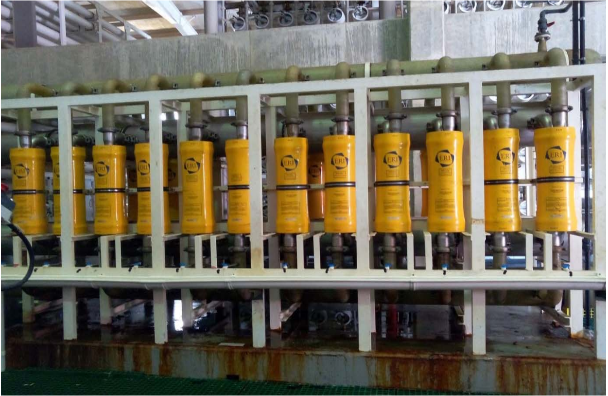
Figure III.04 : Le système de récupération d'énergie de la station de Fouka.
