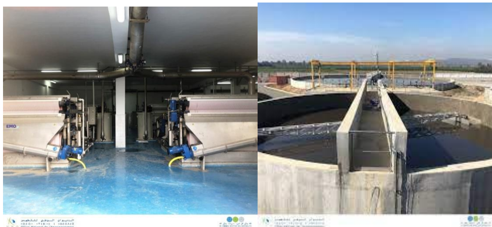
Figures 13 et 14 : la station d'épuration de BOUFARIK Office National de l'Assainissement Officiel D.G
