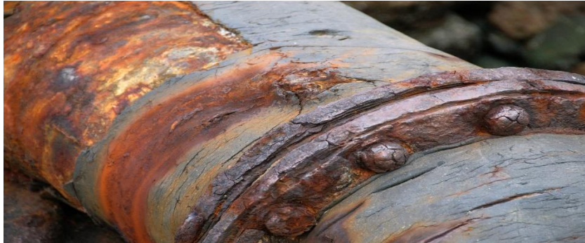
Figure VII.6 : Corrosion externe dans une conduite.
