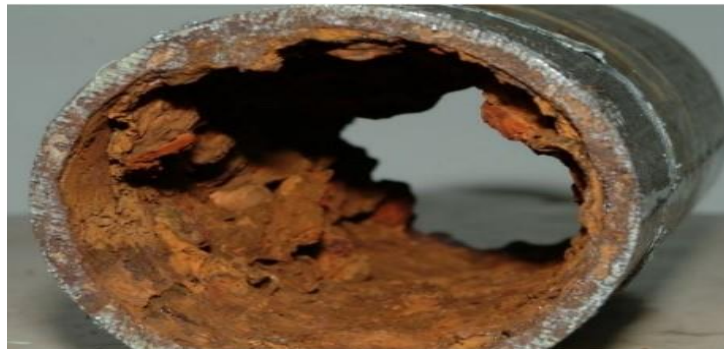
Figure VII.8 : Corrosion interne dans une conduite.
