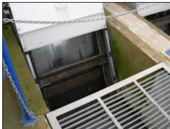
Figure III.3 : Photo du dégrilleur fin (Source : STEP de Beni Messous)
