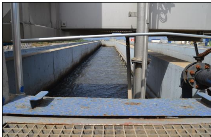
Figure III.5 : Photo du canal de dessablage / déshuileur Tranche 2 (Source : STEP de Beni Messous)
