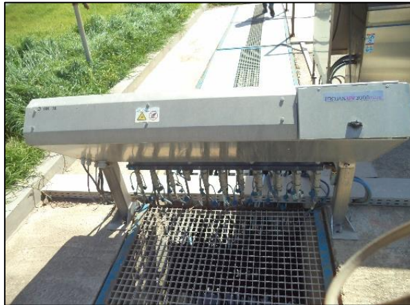
Figure III.14: photo de Canal de désinfection (Source : STEP de Beni Messous)
