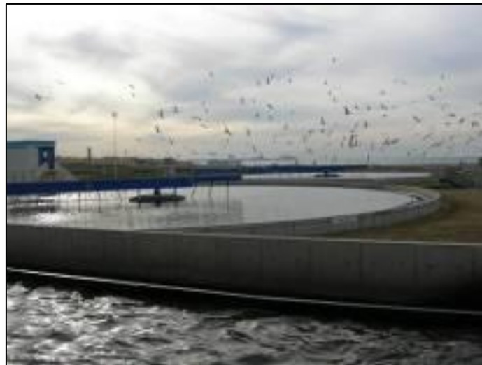
Figure III.9 : Photo de Vue de l'ensemble de clarificateur (Source : STEP de Beni Messous)
