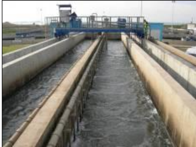
Figure III.4 : Photo du canal de dessablage / déshuileur Tranche 1 (Source : STEP de Beni Messous)
