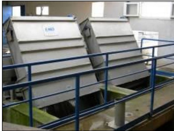
Figure III.2 : Photo du dégrilleur grossier (Source : STEP de Beni Messous)
