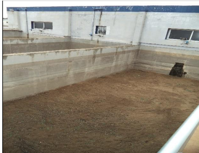
Figure III.13 : filtre à sable hors service (Source : STEP de Beni Messous)
