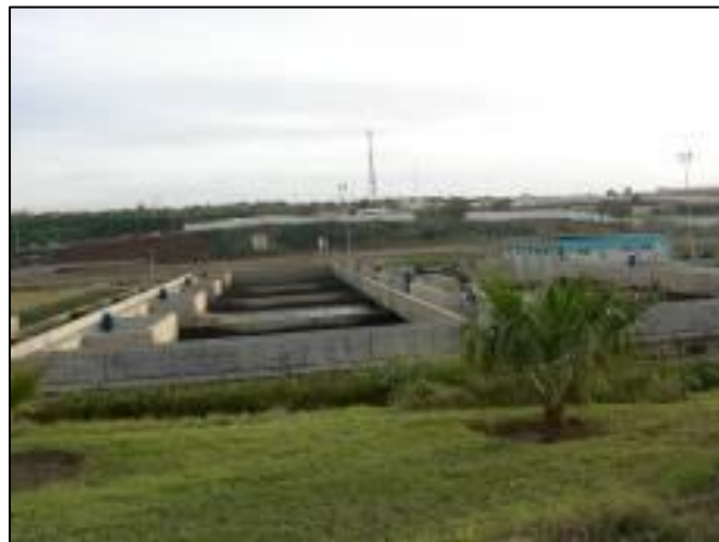
Figure III.8 : Photo de Vue de l'ensemble du bassin d'aération tranche 1 (Source : STEP de Beni Messous)
