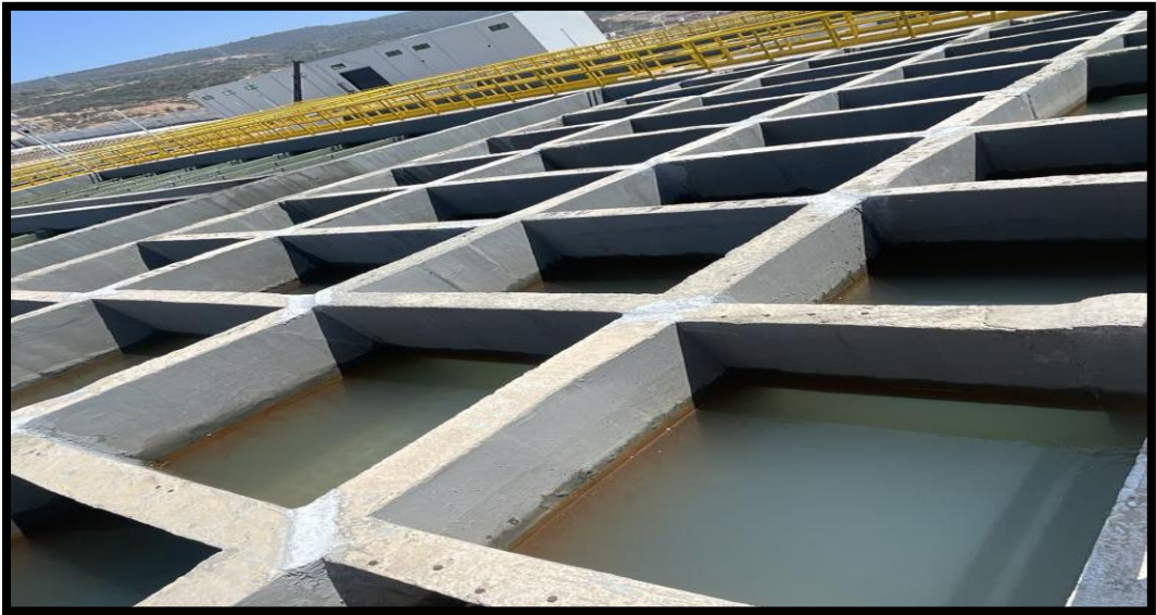
Figure III.12- mélangeur du floculation (décanteur)
