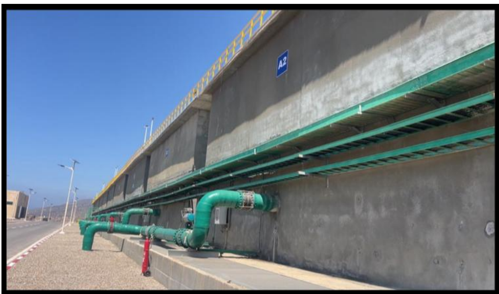
Figure III.11 – Décanteur à agitation mécanique après injection du coagulant
