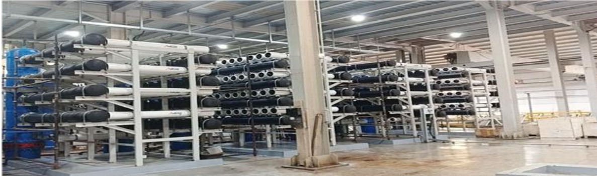
Figure III.16 -les filtres à cartouches de forme racks
