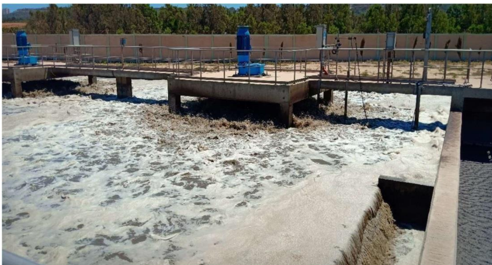
Figure II.5 : Bassin d'aération l'oxygène
