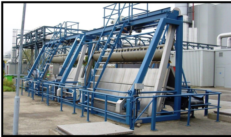
Figure II.2 : Dégrilleur à barres grossières Amy, G. (2008).
