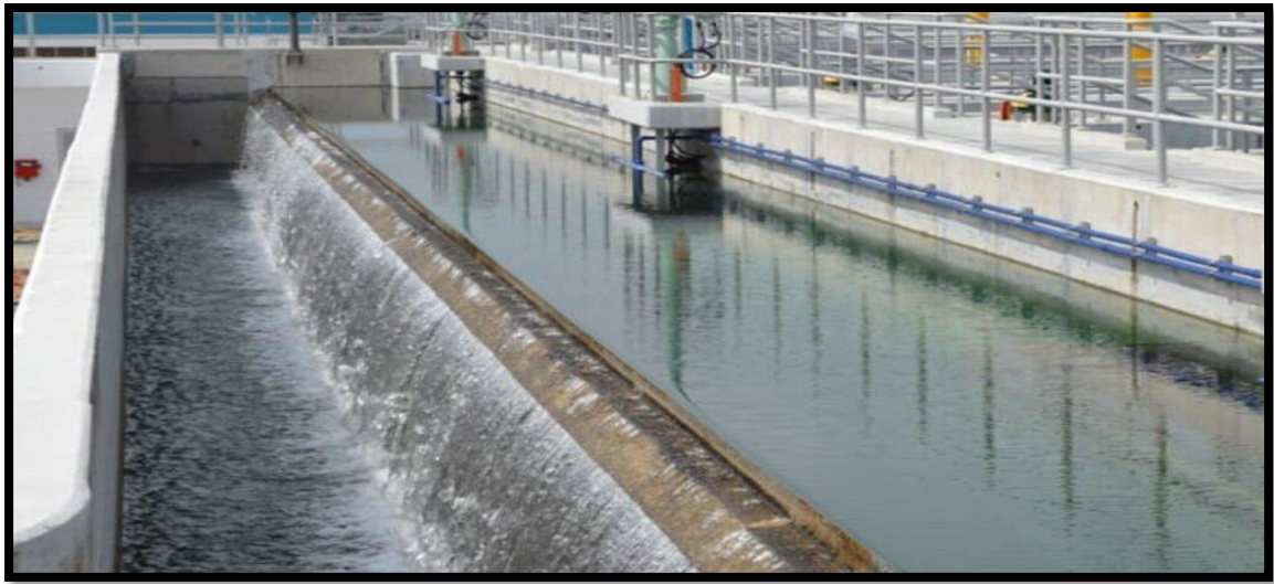
Figure II.6 : Les bassins de décantation Voutchkov, N. (2018).
