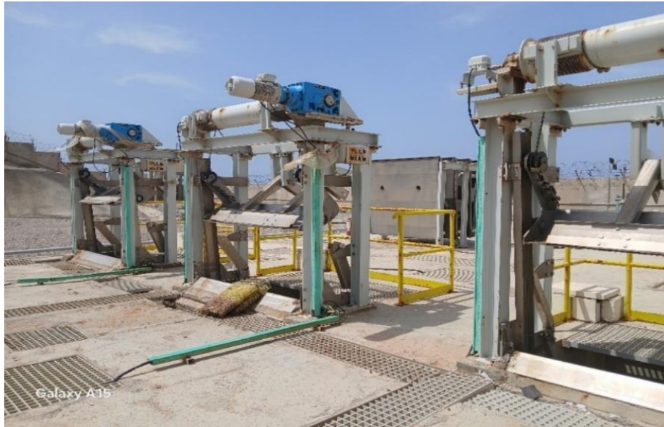
Figure IV. 6 : system de les trois Dégrilleur grossier
