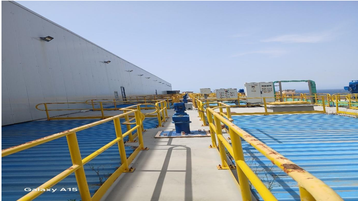
Figure IV. 8 : Les bâches de coagulation
