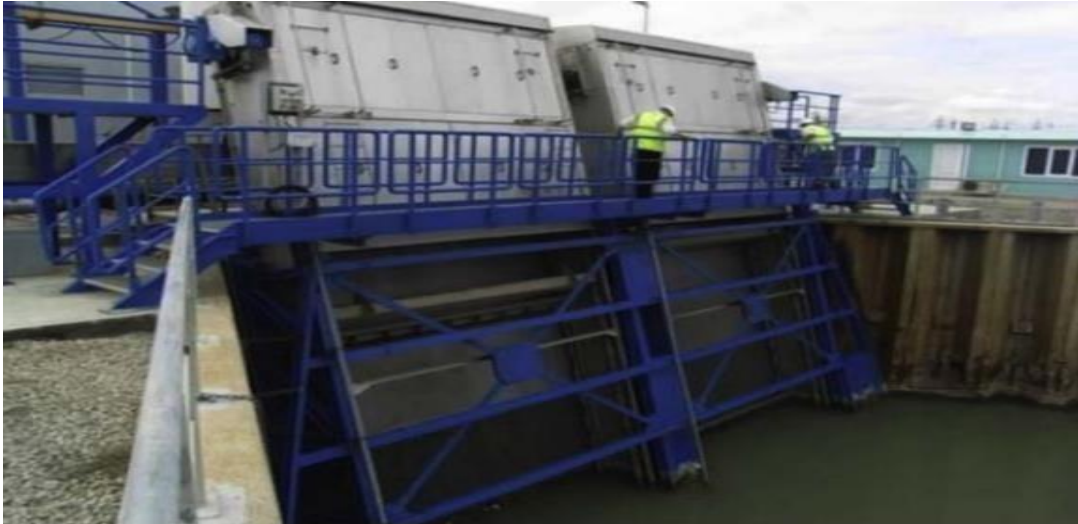
Figure II. 2 : Cribles grossiers de prise à terre
