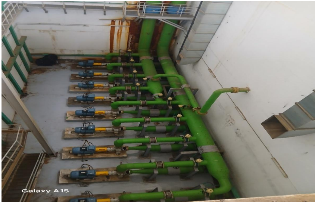
Figure IV. 8 : Les pompes d'eau brute
