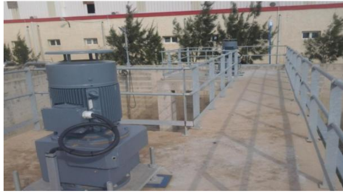
Figure I.8 bassin de control d'odeur de STEP Tonic
