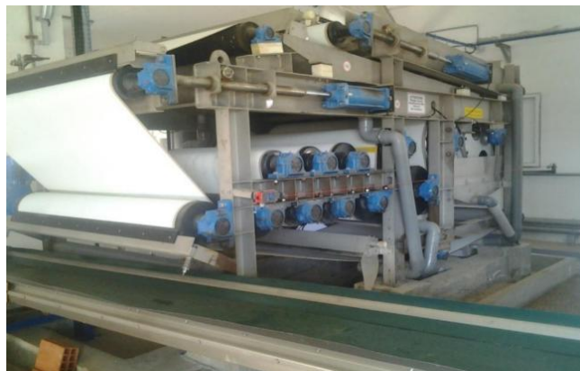
Figure I.11 unité de déshydratation mécanique de STEP Tonic
