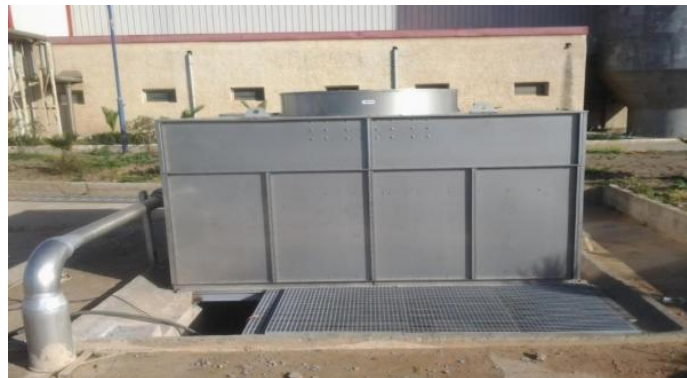
Figure I.7 tour de refroidissement de STEP Tonic
