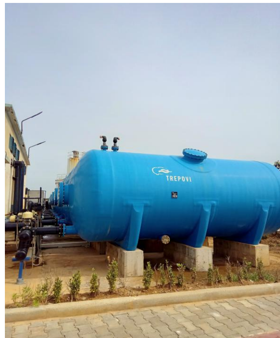
Figure III.4 : Vue proche de filtre à sable
