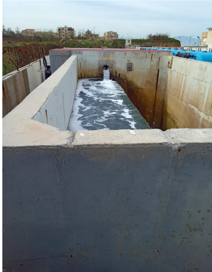
Figure III.19 : Bassin de saumure
