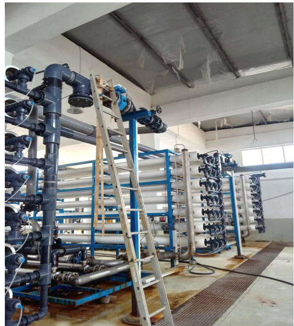
Figure III.13 : Unité de RO
