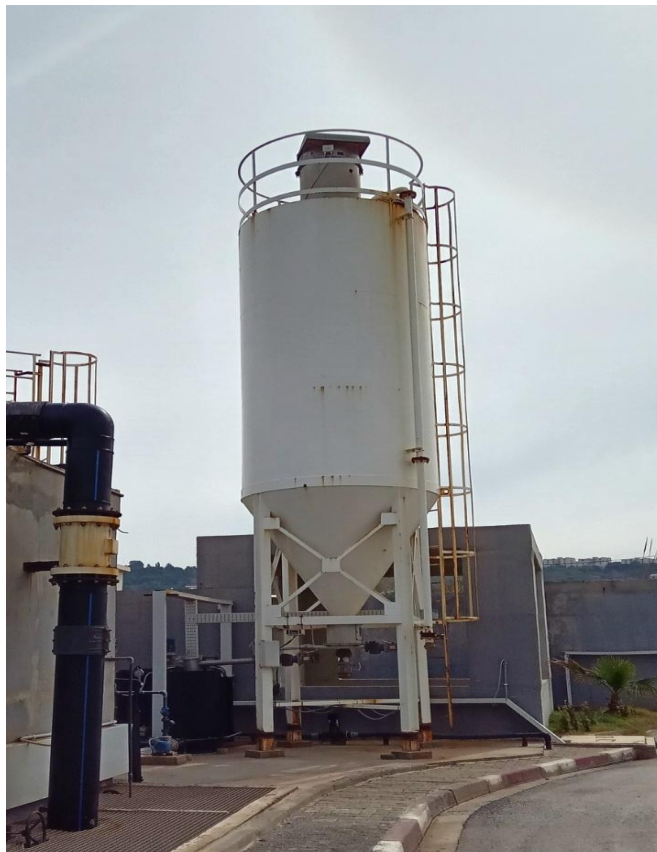
Figure IV.17 : Système dosage de lait de chaux
