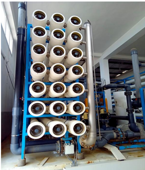
Figure III.14 : Un rack de RO (membranes spiralées)
