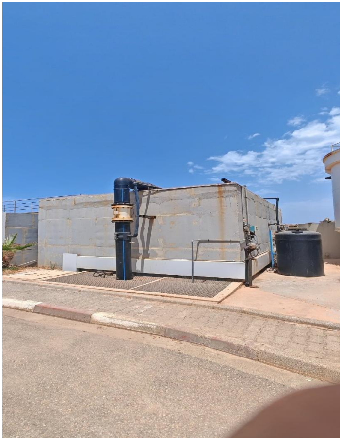
Figure III.18 : Bassin de stockage d'eau traitée et dosage NaClO
