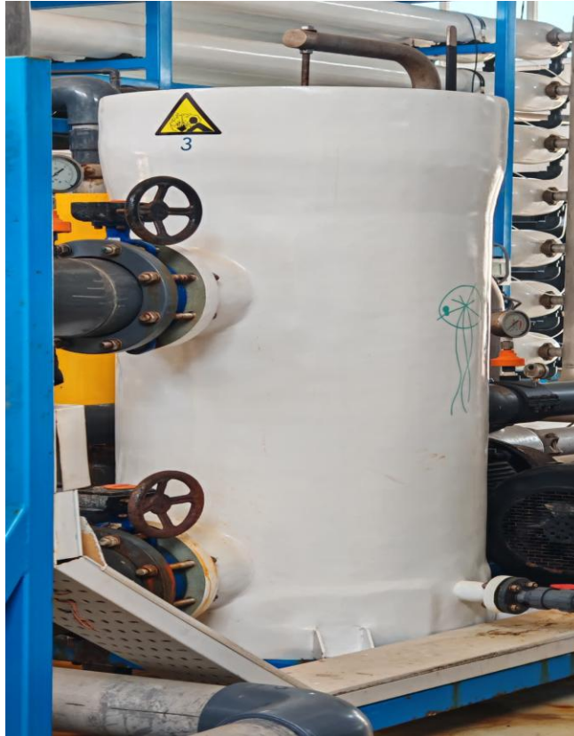
Figure III.8 : L'unité de microfiltration
