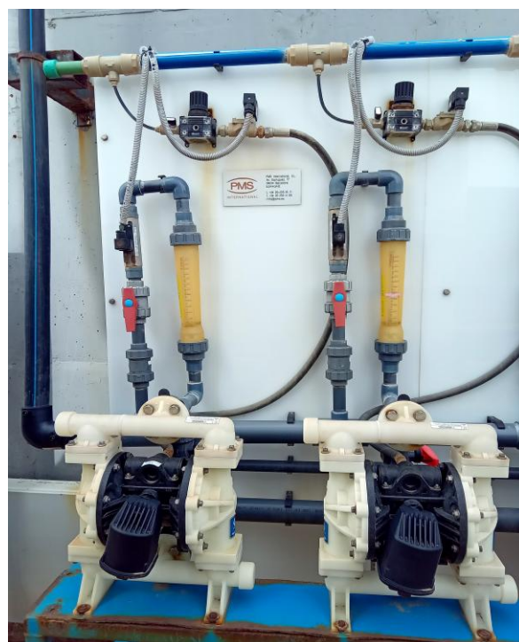
Figure III.10 : Pompes doseuses à membrane pneumatique
