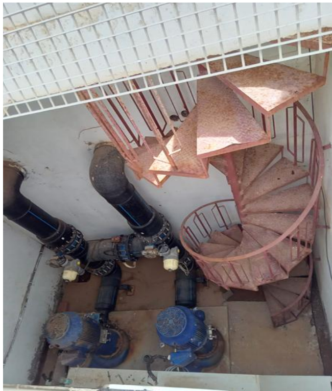
Figure III.2 : Pompes d'amorçage au niveau de captage
