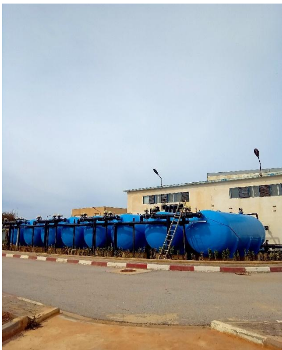
Figure III.5 : Filtres à sable
