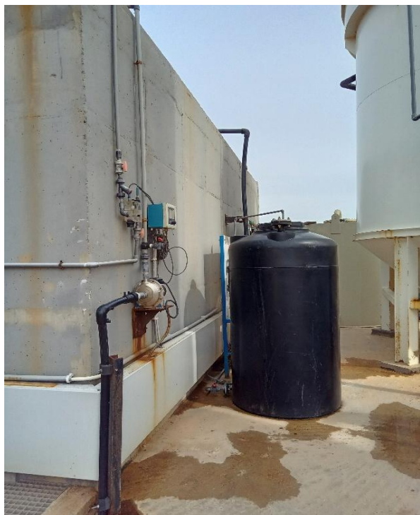
Figure III.9 : Cuve de stockage de (NaClO)
