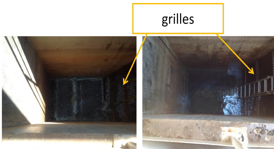
Figure III.20 : installation de Dégrileurs.
