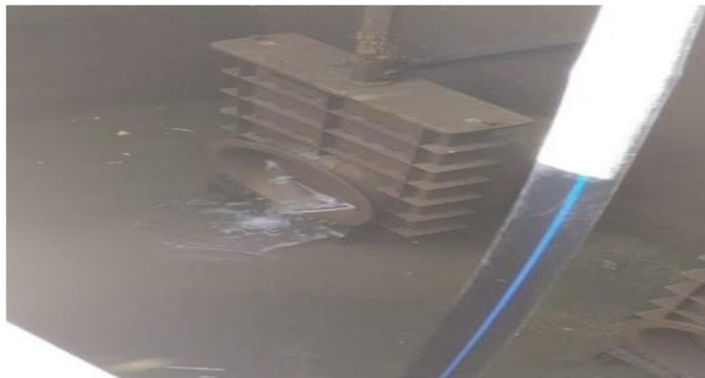
Figure III.19 : La vanne d'isolement de la bache d'admission
