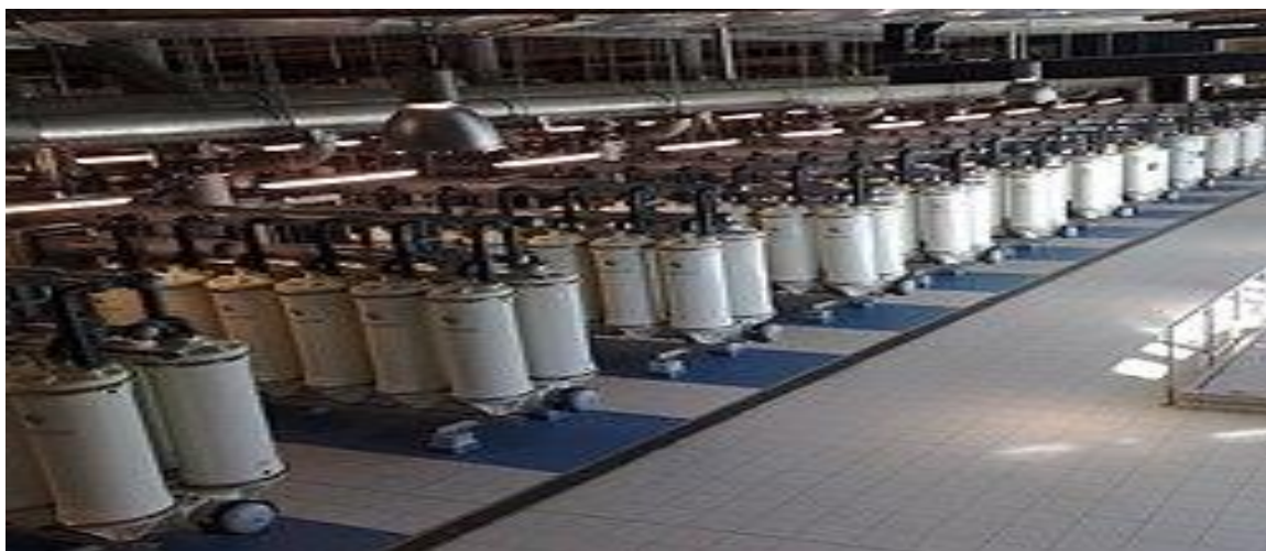
Figure II.15 : photo d'une Unités d'ultrafiltration
