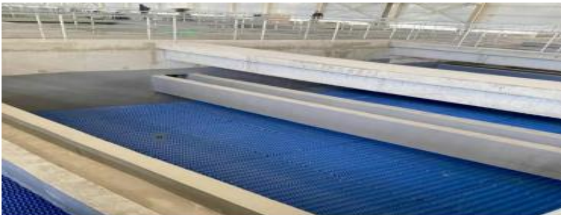
Figure III.24 : photo de décanteur laminaire
