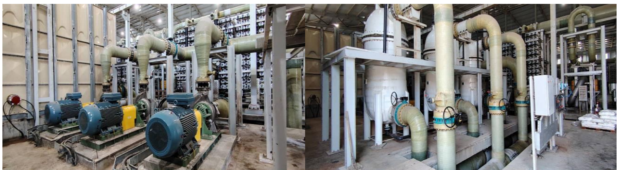
Figure III. 13 : système de lavage CIP
