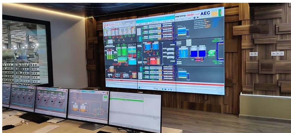
Figure III. 18 : salle de contrôle
