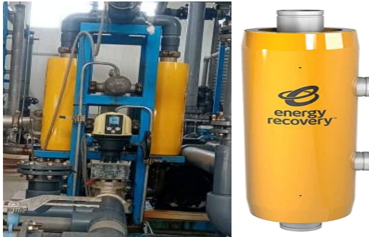
Figure23 : Équipement de récupération d'énergie
