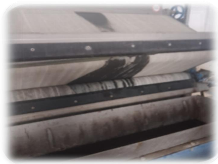
Figure III.13 : Epaississeur des boues.
