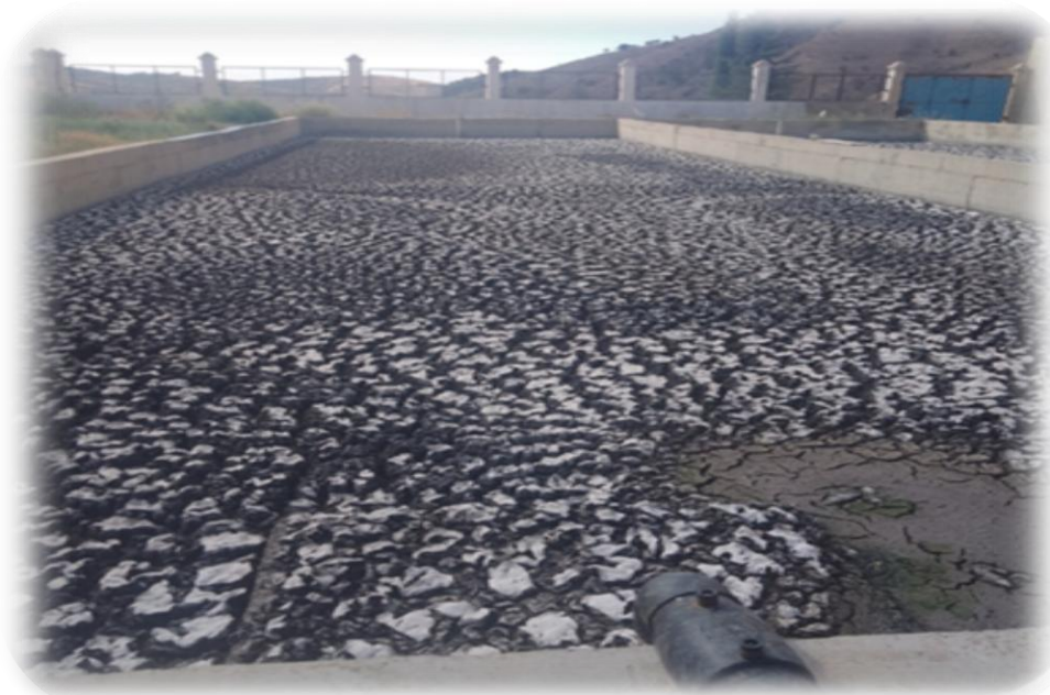
Figure III.14 : Lit de séchage.
