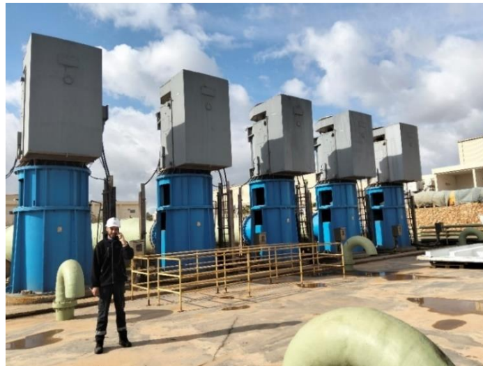
Figure III. 4 : système de pompage de prise d'eau
