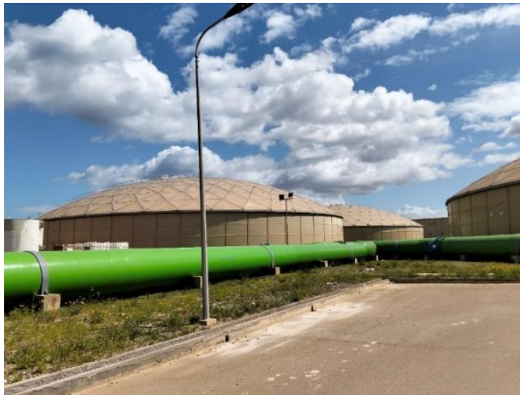
Figure III. 9 : Réservoir de stockage
