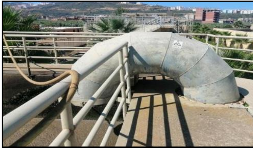
Photo II. 5 : la conduite des boues de retour
