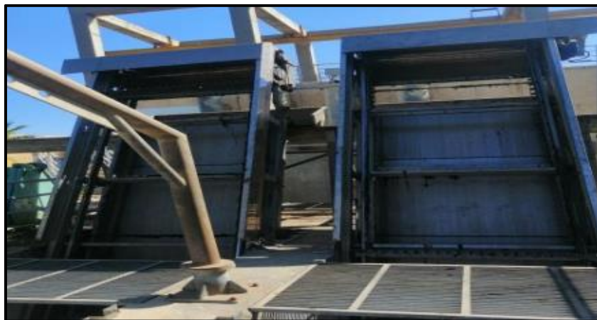
Photo II. 3 : les dégrilleurs grossiers automatiques
