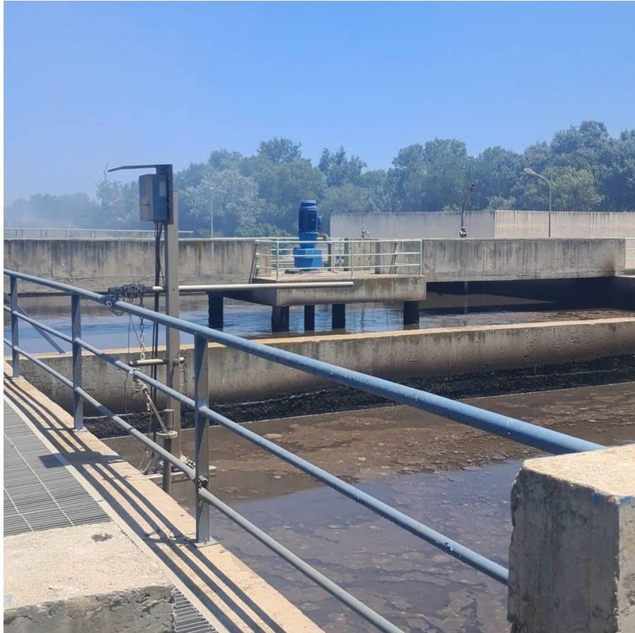
FIGURE 3.4 – Le bassin d'aération de la STEP de SET ( Image prise par Thiziri )
