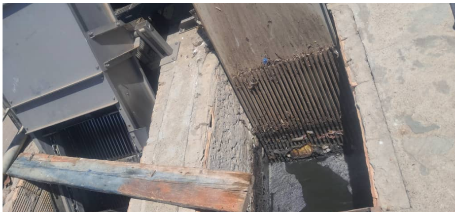
FIGURE 3.2 – Le dégrilleur de la STEP de SET ( Image prise par Thiziri )
