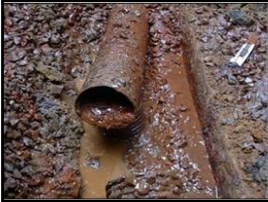
Figure V.1 : un drain colmaté par des dépôts chimiques
