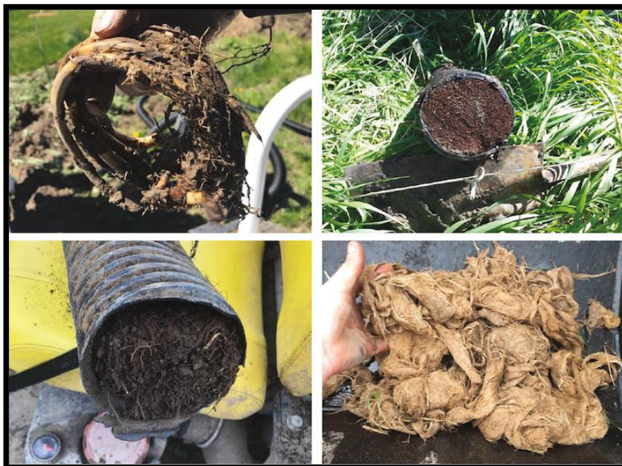
Figure V.2 : des drains colmatés par des racines des plantes.
